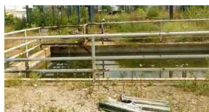
電解工場からの排水沈殿池
