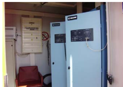
写真 2-1.4 既設 VOR/DME 装置
