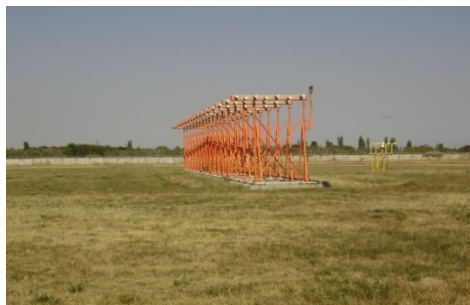
写真 2-1.5 既設 LLZ 空中線装置
