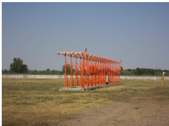
写真-1：滑走路 08 側進入用の計器着陸装置 (ILS) の構成要素の一つであるローカライザー (LLZ)。円借款事業により 1999 年に設置され、カテゴリ-II で運用中。2014 年には部品供給が終了する予定。
