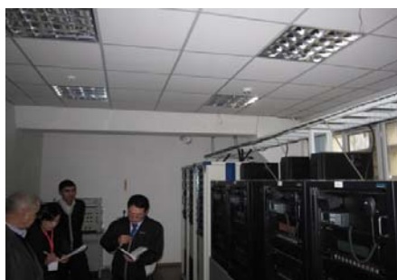
写真 2-1.1 運用庁舎通信機器室
