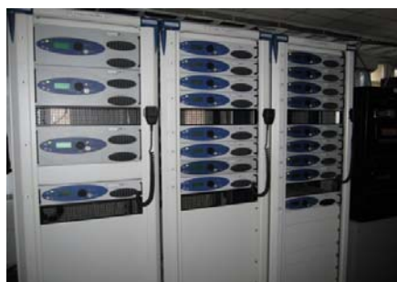
写真 2-1.2 既設 VHF 無線電話機
