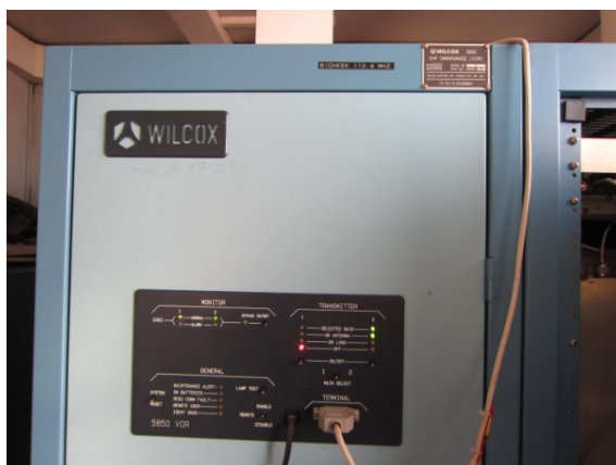
写真-6：写真-5 のシェルター内にある VOR/DME 機器。1995 年に設置された米国 WILCOX 社製。
