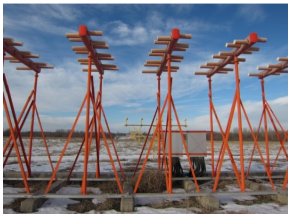
写真-3：滑走路 26 側進入用のローカライザー (LLZ)。形式、カテゴリ、設置年は 08 側と同じ。ILS 進入コースの水平方向の電波を発信している。
