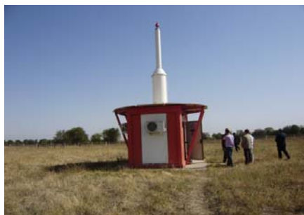
写真 2-1.3 既設 VOR/DME 施設
