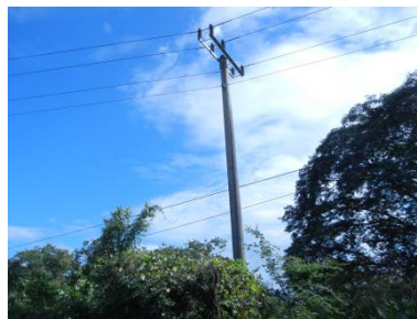
電力ケーブルおよび電柱
