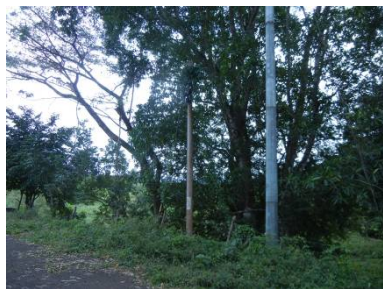
通信ケーブルおよび電柱
