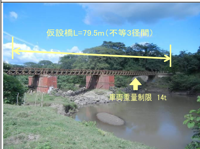
写真-9：現在使用されている脆弱な仮設橋
