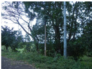
通信ケーブルおよび電柱
