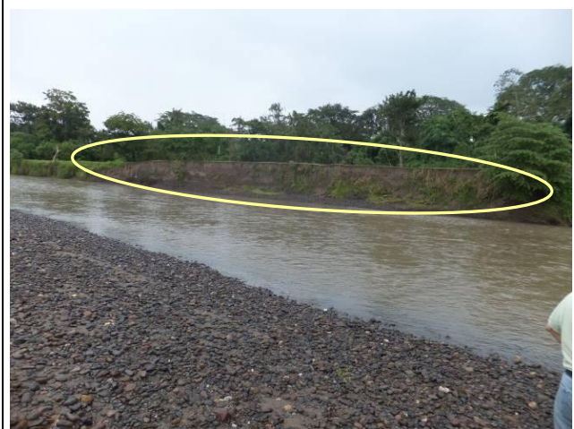
写真-15：上流水衝部の河岸洗掘
