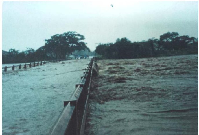
写真 3-2.1 旧パソ・レアル橋の流失時の状況
