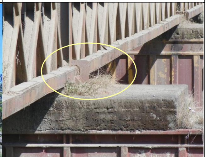
写真-12：上部と下部との脆弱なずれ止め構造
