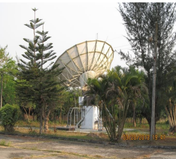
タンリン国際衛星地上局 (Ku バンド) アンテナ ヤンゴン(ITMC)からタンリンまで約 27 km、12 芯光ケーブルにて接続されている。トラフィックの増加に伴い本計画では DWDM(40 Gbps) の多重化伝送装置を設備し、回線の増設を図る。
