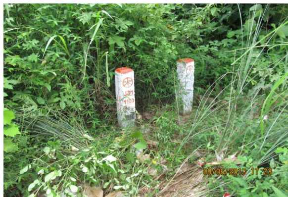
Pyay 中継所 (中小 10 都市の調査より) バックボーン用光ケーブルのハンドホールが埋設され ており、標識が立っている。
