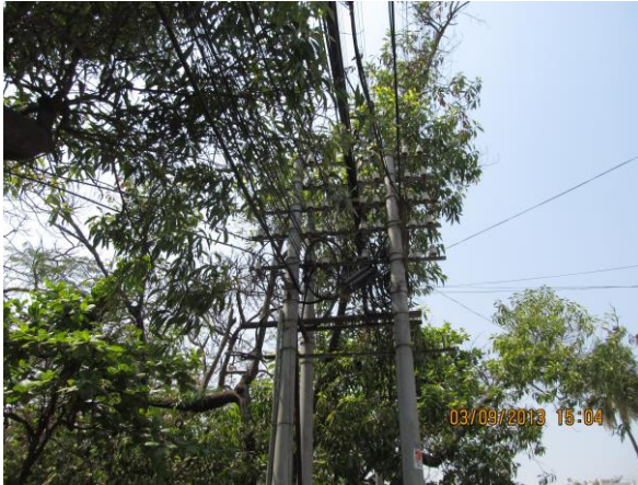
マンダレー中央局前の架空光ケーブル敷設状況。木立と接触、他ケーブルの混在、外観などの問題がある。本計画では、主に地下管路埋設を予定している。
