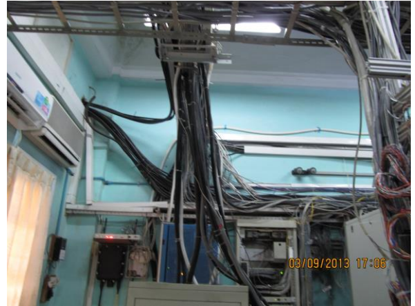
マンダレー中央局機械室の配線状況。障害時の配線識別が難しく、線材に不要な荷重が掛るため整然とした配線、縫縛が望まれる。
