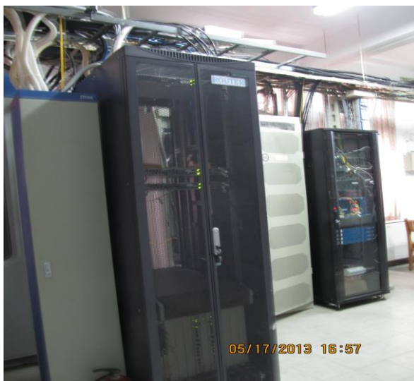
ヤンゴン、Shwegondine 携帯・無線基地局 BTS 及びルーター架、中国製である。
