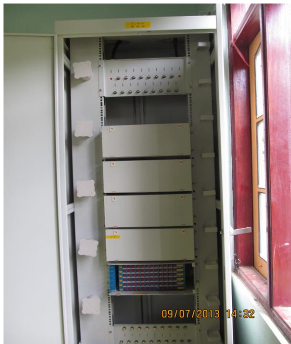
Zegone 交換局 (中小 10 都市の調査より) バックボーン用光ケーブル成端架
