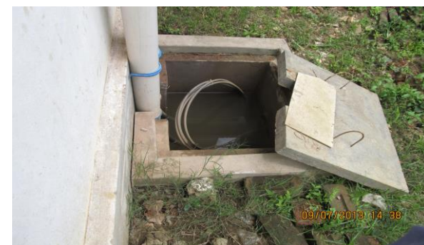
Zegone 交換局 (中小 10 都市の調査より) 光ケーブル用局前マンホールに水が溜っている。
