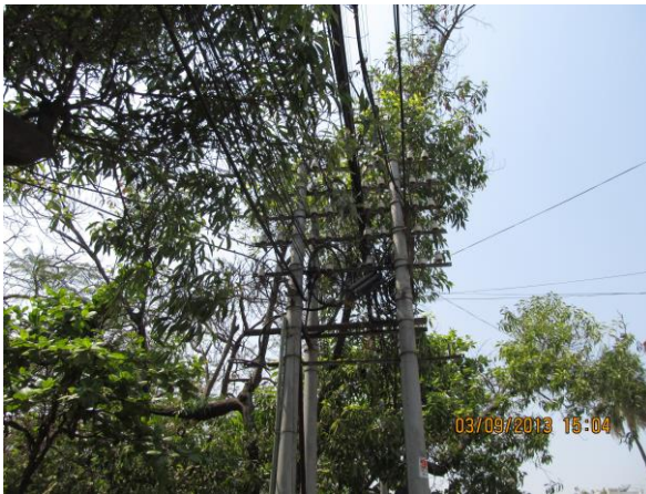
マンダレー中央局前の架空光ケーブル敷設状況。木立と接触、他ケーブルの混在、外観などの問題がある。本計画では、主に地下管路埋設を予定している。
