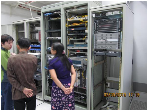
マンダレー中央局伝送機器室、2013 年末に完成した日本政府無償援助による通信網緊急改善事業で導入された基幹ルータ群が設置されている。
