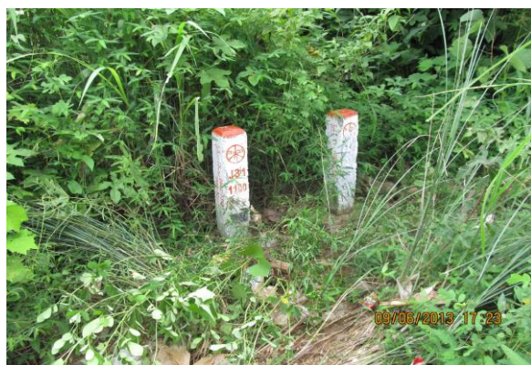
Pyay 中継所 (中小 10 都市の調査より) バックボーン用光ケーブルのハンドホールが埋設され ており、標識が立っている。
