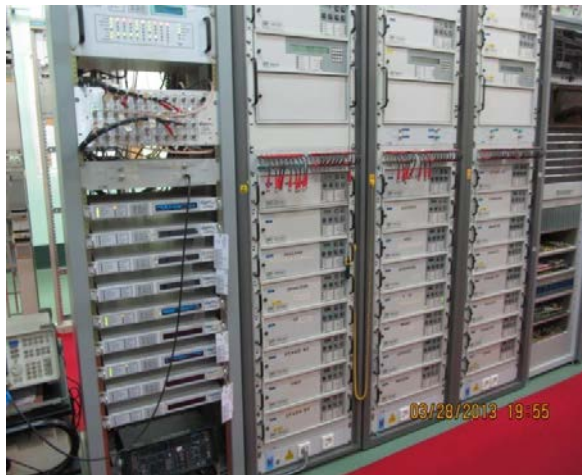
タンリン国際衛星地上局国際通信機器室 写真の右の3架に各国向け回線が収容されている。因みに、日本向けは27+30 電話回線 (2+2Mbps) である。
