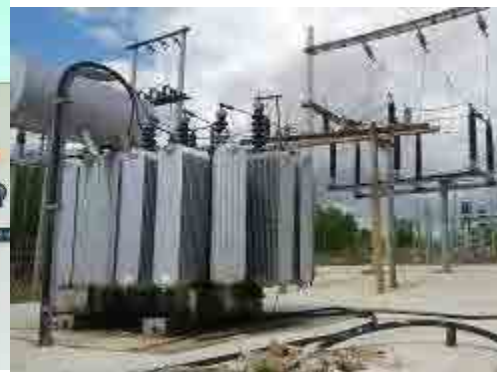
ニューバガンタウン変電所
