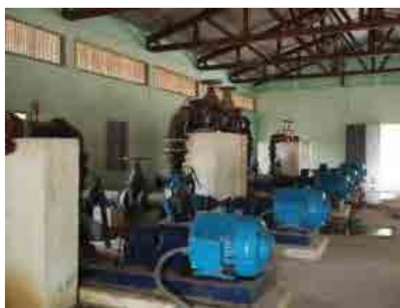
ポンプ場 No.2 取水された水を沈殿池へ送り、その後給水する。
