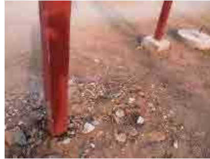
旧方向標示板の土台は地面に埋め込まれており、根元が腐りやすい。
