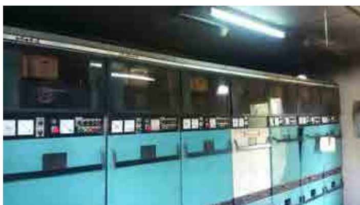
ニャンウータウン変電所(1)1989 年に建設 古いフィーダーがあるが、稼働しているのは3 つだけ。
