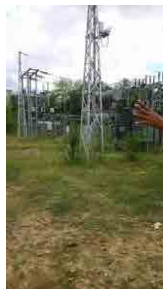
ニャンウータウン変電所(1)
