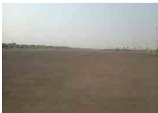
滑走路の舗装が劣化している。空港の機能としては、有視界飛行を前提としている。
