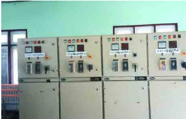
ニューバガンタウン変電所にあるフィーダー
