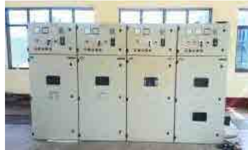
ニャンウータウン変電所(2) 新しいフィーダーがある
