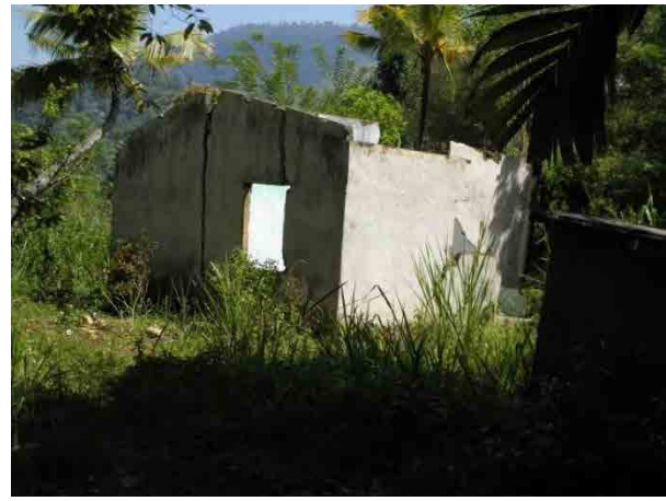
バドウルシリガマ地すべりの被災建物 (パイロット事業実施予定箇所)
