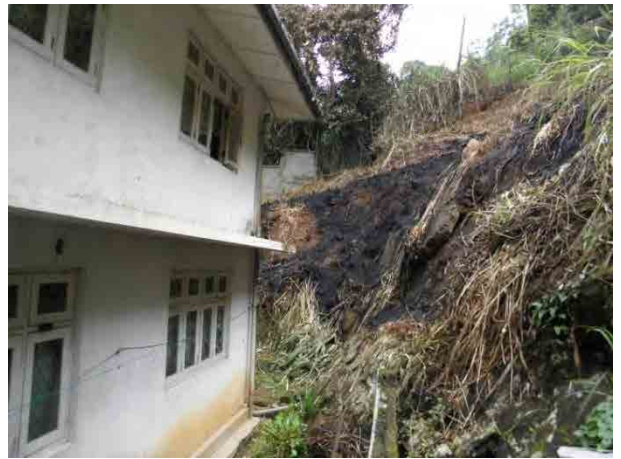
センカダガラ障害児学校裏の岩すべり 危険斜面 (実施しない箇所)
