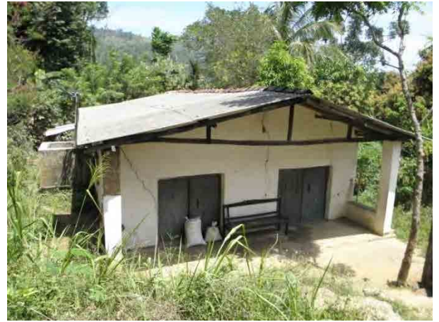
ウダマドゥラ地すべり内の被災した住宅 (パイロット事業実施予定箇所)
