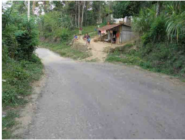
ウダマドゥラ地すべり内の道路面の変形 (パイロット事業実施予定箇所)
