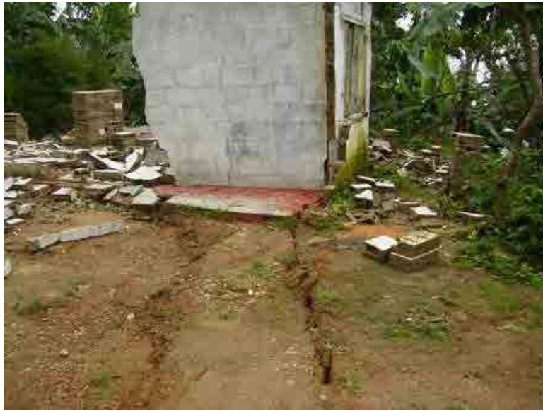
図 3-1-6 マハウエワ地区の地すべり被害 (NBRO)
