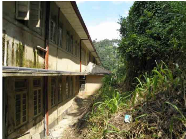
崩壊した Nurse's Training College 背後斜面 (パイロット事業実施予定箇所)
