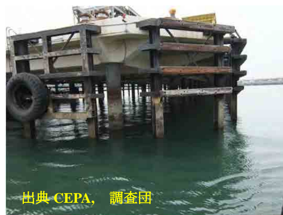
図 8.12 B 岸壁の鋼管杭の現状
