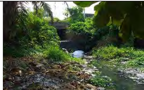
写真-32 ブェンジ排水路流出口現況 土砂、ゴミが港内水域に流入する
