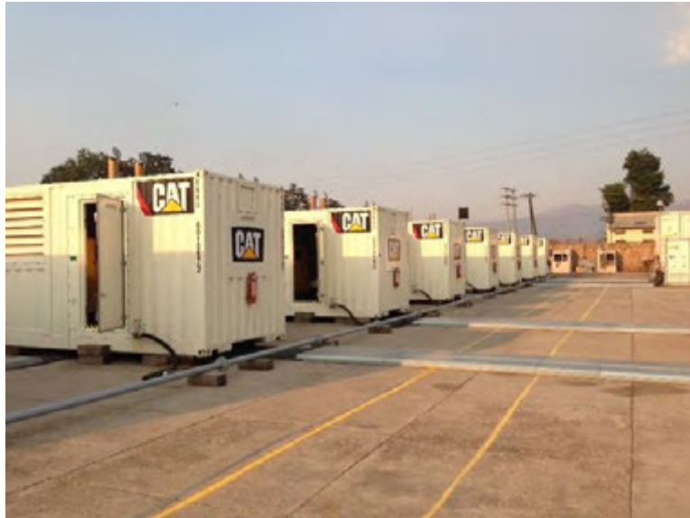
写真 2-3 稼働準備中のディーゼル発電プラント
