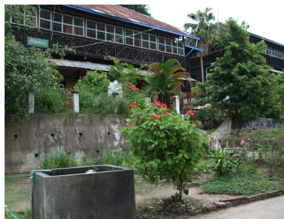
No. 4 現在のタウンゲーEC。高台にある木軸構造で築 60 年程度の教室棟(1 階が教室、2 階が学生寮)で、建物全体で老朽化が著しい。
