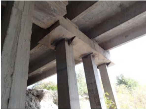
Kara-Kol に位置する橋梁 ：橋脚の柱と梁がプレキャストブロックであり、耐震上、好ましくない。
