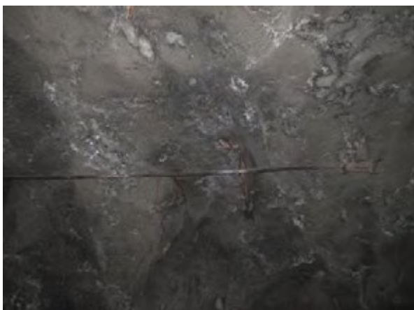
Kara-Kol 郊外のトンネル：トンネル天端や側壁付近に吹付けコンクリートの剥落が確認できる。
