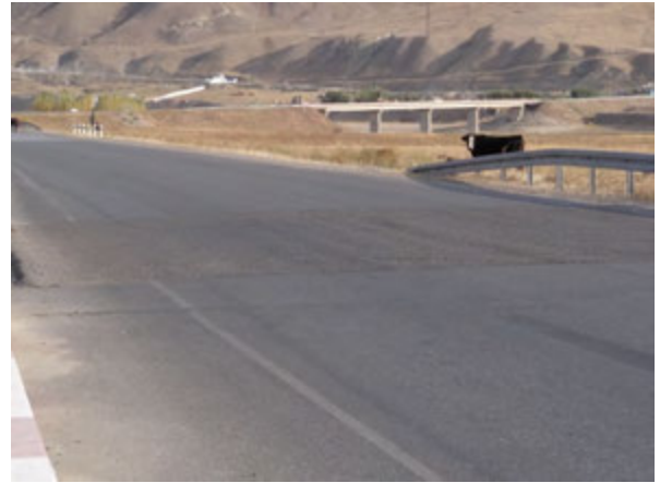
Toktogul 近郊の橋梁 ：橋梁アプローチ部に施工不良が原因で沈下している箇所がある。
