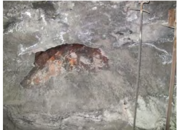
Kara-Kol 郊外のトンネル：トンネル坑奥部の天端や側壁部分に地山崩落が認められる。
