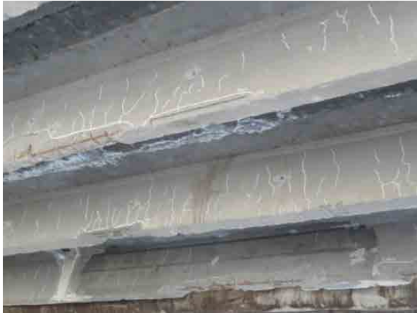
写真 2-5-4 橋梁曲げひび割れ状況
