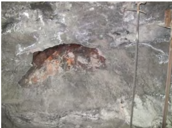
写真 2-5-6 トンネル No.2 天端崩落状況
