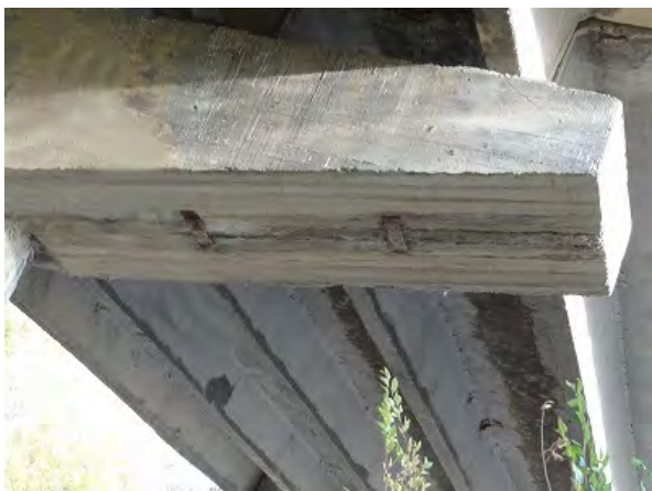
Toktogul 近郊の橋梁 ：梁部がプレキャストブロックであり、間詰コンクリートに損傷が発生し始めている。耐震上、不安定な状況にある。
