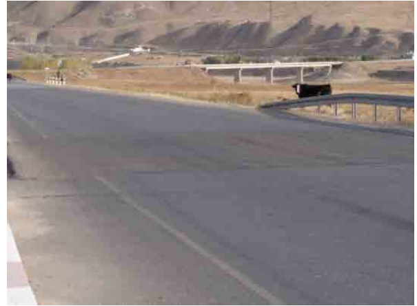
写真 2-5-5 橋梁アプローチ部の沈下状況
