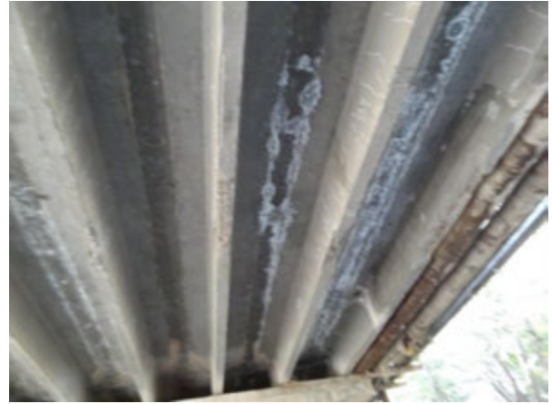
Kara-Kol に位置する橋梁 ：桁の小さなクラックや桁間の間詰コンクリートに遊離石灰がみられる。横桁が設置されておらず、車両の影響が分散されないため、構造上、安定していない。
