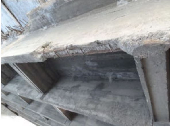
Kara-Kol に位置する橋梁 ：橋梁全体を見ると横桁が格子状に設置されており、安定した構造となっている。しかし桁下の施工不良により鉄筋が露出している。
