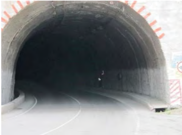
Kara-Kol 郊外のトンネル：トンネル内に照明設備はあるものの、故障により機能しておらず、それらのケーブル等が垂れ下がっている状況である。
