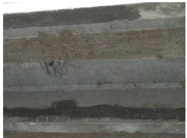
Toktogul 近郊の橋梁 ：上部工の間詰コンクリートが施工不良により、コンクリートが剥落し、鉄筋が露出している。
