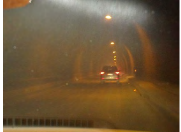
Too-Ashuu 峠に位置する Kolvaev トンネル：換気設備は設置されているものの、トンネル内は排気ガスが充満している状況である。
