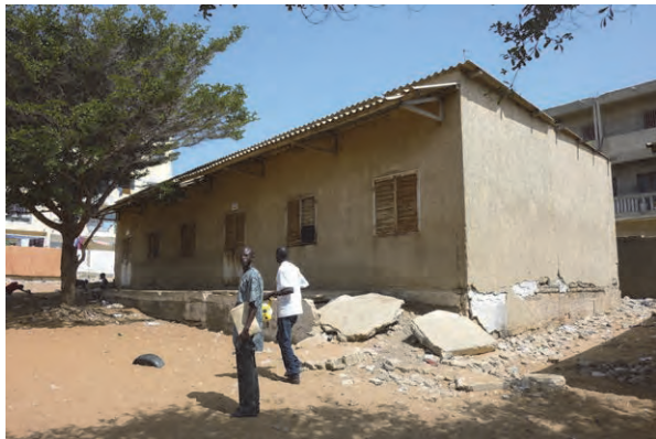
既存中学校の施設の状況 基礎の鉄筋が錆びて爆裂を起こしている。(BD-07 パルセル・アセニ・ユニテ 18 中学校)
