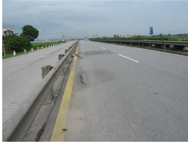
Ảnh 5.5.17 Lún lõm mặt đường nhựa
