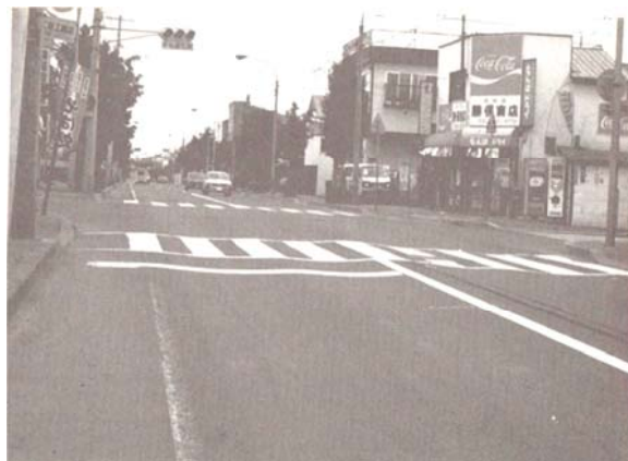
Ảnh 5.5.14 Lún vệt bánh do biến dạng của lớp bê tông nặng
