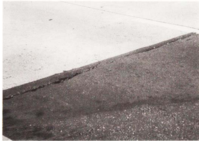
Ảnh 5.6.3 Ghồ ghề giữa tấm bê tông xi măng mặt đường và phần mặt đường nhựa
