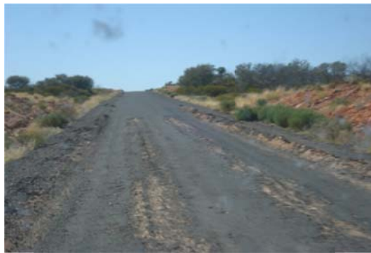
Ảnh 5.5.3 Bong rời vật liệu bề mặt mặt đường nhựa
