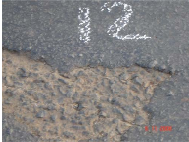
Ảnh 5.5.2 Bong tróc và bong bột mặt đường nhựa
