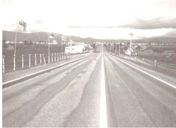
Ảnh 5.5.15 Lún vệt bánh do mài mòn vật liệu bê tông nhựa mặt đường
