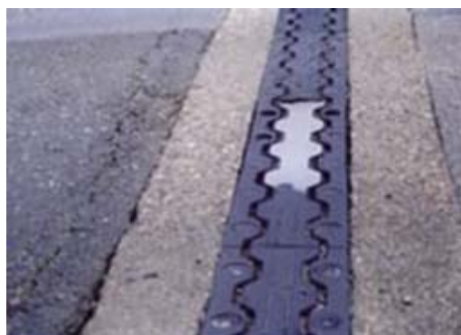
H23.5 Đứt quãng lớp cao su trên cùng tại khe co giãn
