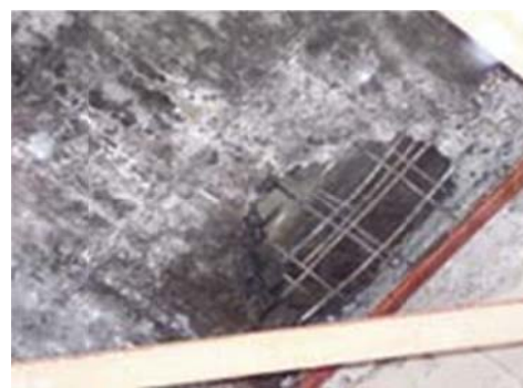
H11.12 Rơi khối bê tông tại đáy của bản mặt cầu
