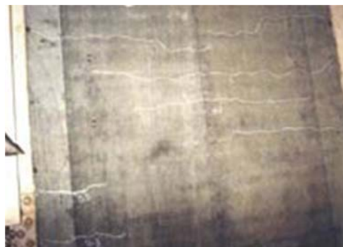
H11.2 Nứt một hướng tại đáy của bản mặt cầu
