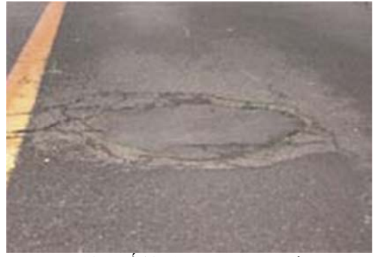
H14.6 Hố lún (trũng) trên mặt đường
