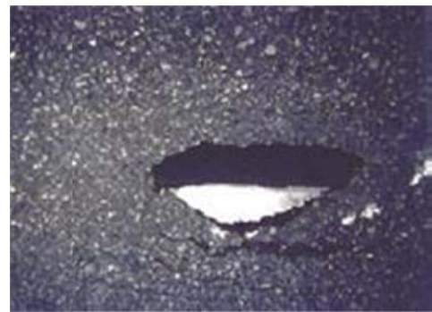
2) Ổ gà trên mặt đường atphan
