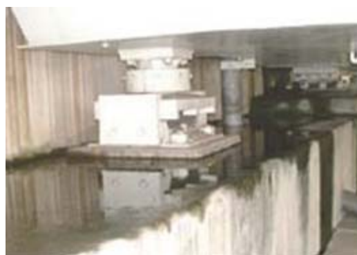
H20.5 Nước đọng tại chân gối cầu
