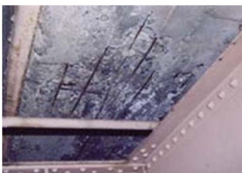
H7.11. Bong tróc bê tông và cốt thép bị lộ ra tại bản mặt cầu
