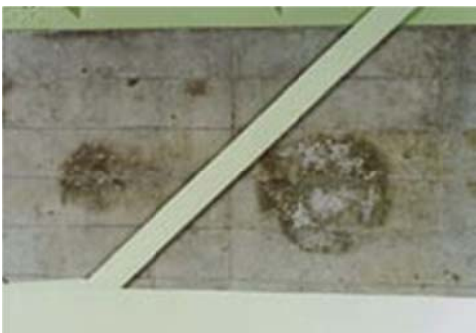
H8.11 Rò rỉ nước tại bản mặt cầu
