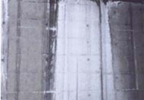
H8.7 Thoát nước qua bề mặt và xuất hiện vôi bột
