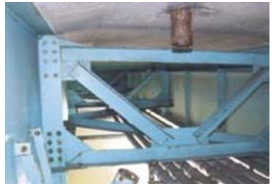
H20.11 Đứt gãy với ống thoát nước
