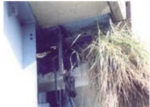
H24.6 Cổng thoát nước bị chất đông mảnh vụn và rác.
