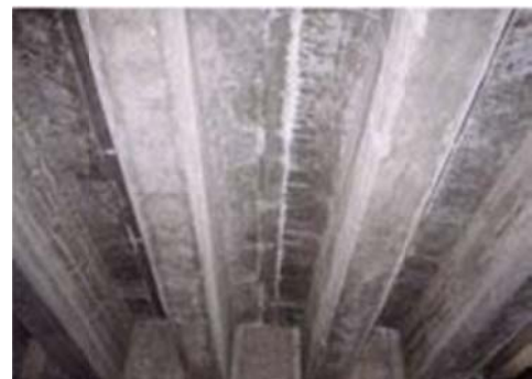
H9.5 Bê tông bản đệm có rò rỉ nước
