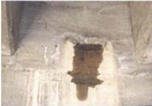
H20.6 Nước rò rỉ từ vị trí bê tông mói bị vỡ
