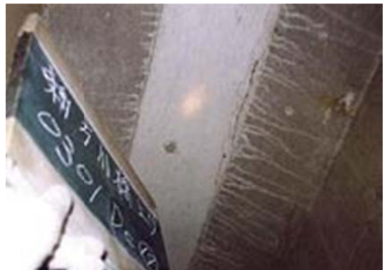
H6.10. Nứt trên bản mặt cầu giữa các dầm
