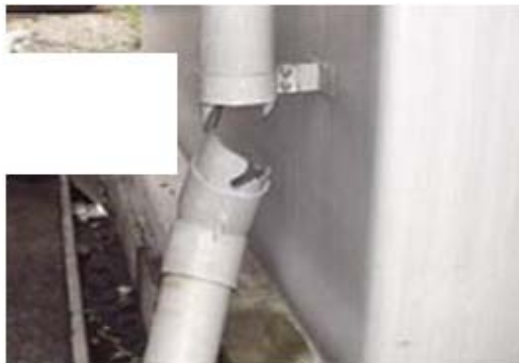
H20.8 Đứt gãy với ống thoát nước
