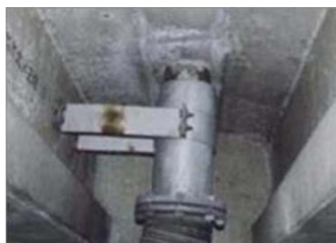
H5.4. Hư rỉ trên bề mặt mạ kẽm
