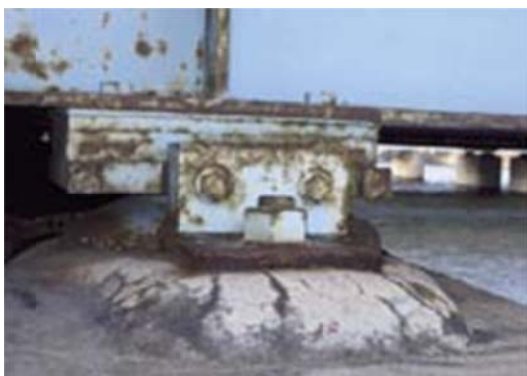
H16.9 Hư hỏng tại khối vữa xây tại chân gối cầu
