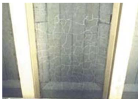
H11.6 Nứt hình chữ nhật tại đáy của bản mặt cầu
