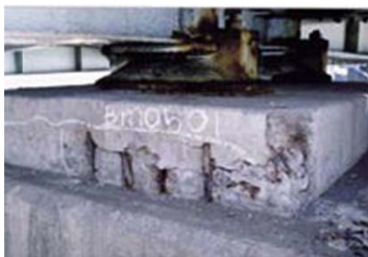
H16.11 Hư hỏng bê tông đế của gối cầu
