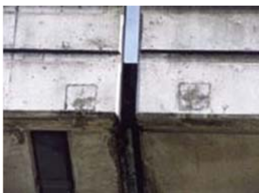
H18.1 Nứt tại phần bê tông neo
