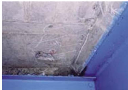
H12.8 Phồng và bong tróc tại đáy của bán mặt cầu
