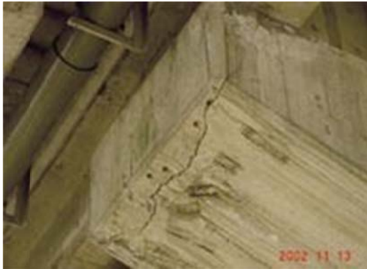
H6.7. Bong tróc bê tông và cốt thép lộ ra và các vết nứt
