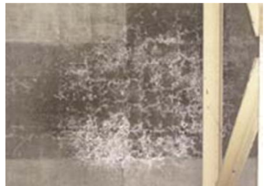
3) Nứt và vôi bột tại đáy của bản mặt cầu
