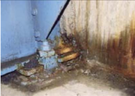
H13.7 Biến dạng gối cầu do sự va chạm giữa dầm và móng
