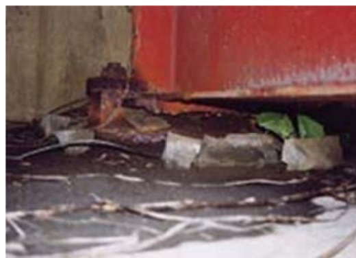
H16.10 Hư hỏng tại khối vữa xây tại chân gối cầu
