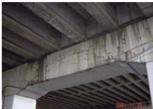
H6.4. Dầm trụ khung cứng bị nứt
