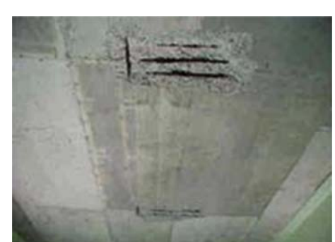
H7.12. Bong tróc bê tông và cốt thép bị lộ ra tại bản mặt cầu cầu
