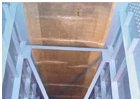
H11.1 Nứt một hướng tại đáy của bản mặt cầu
