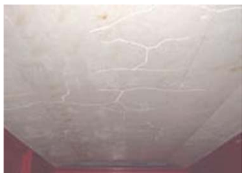
H11.3 Nứt hai hướng tại đáy của bản mặt cầu
