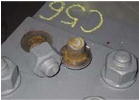
H3.3 Bu lông bị đứt gãy
