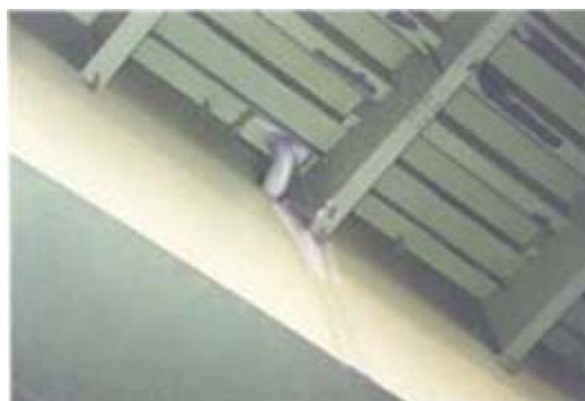
H20.2 Rò rỉ nước từ đường ống thoát nước
