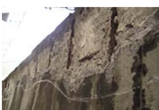
H7.6. Bong tróc bê tông, cốt thép lộ ra
