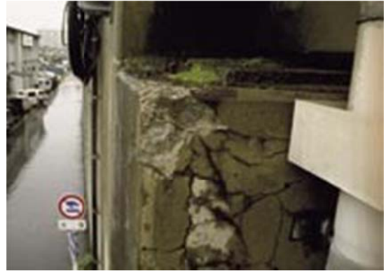
H6.8. Bong tróc bê tông và các vết nứt
