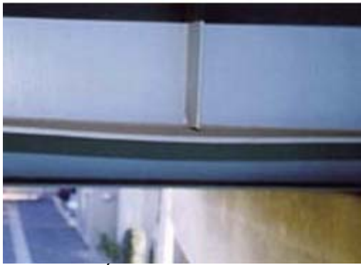
H23.7 Biến dạng và nứt tại cánh dưới của dầm dọc
