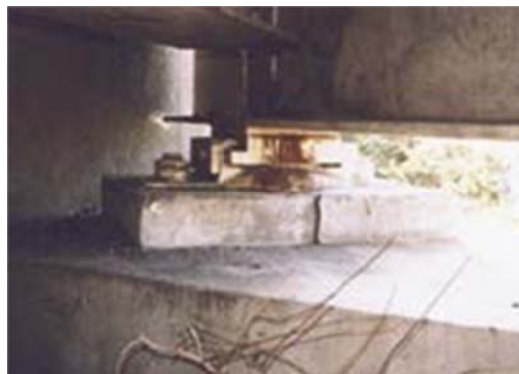
H16.12 Hư hỏng bê tông đế của gối cầu
