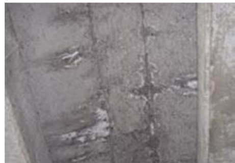
H8.12 Rò rỉ nước tại bản mặt cầu
