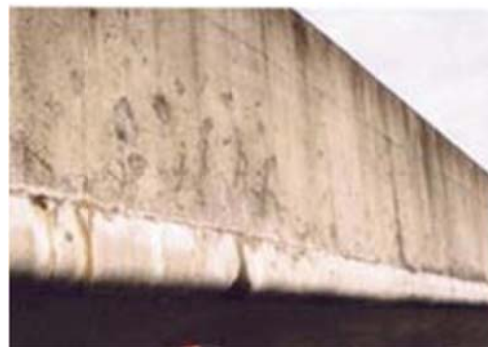
H8.2 Vôi bột xuất hiện trên bản mặt cầu hẫng và vỉa
