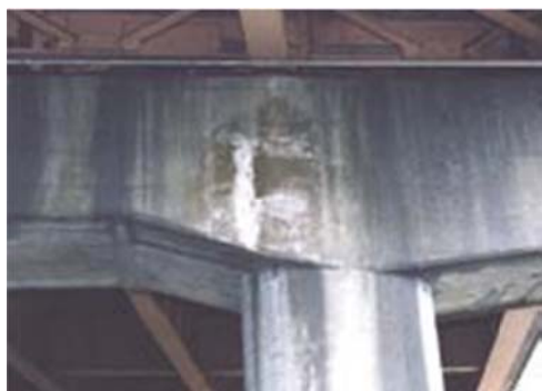
H8.5 Vôi bột từ các vết nứt trên trụ khung cứng
