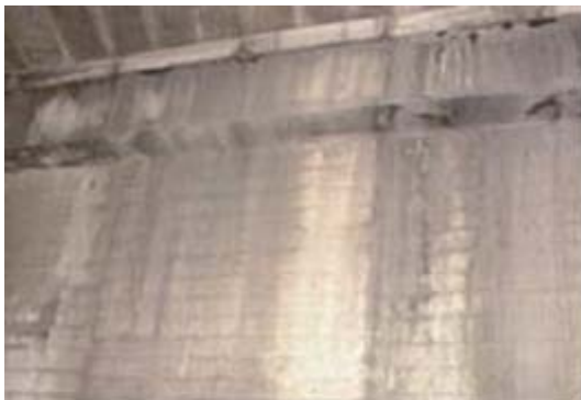
H19.7 Phai màu trên bề mặt bê tông do nước chảy
