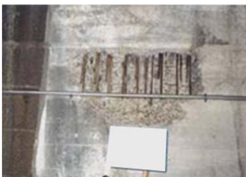
H7.5. Bong tróc bê tông, cốt thép lộ ra
