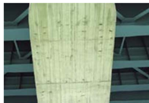
H7.4. Bong tróc bê tông, cốt thép lộ ra
