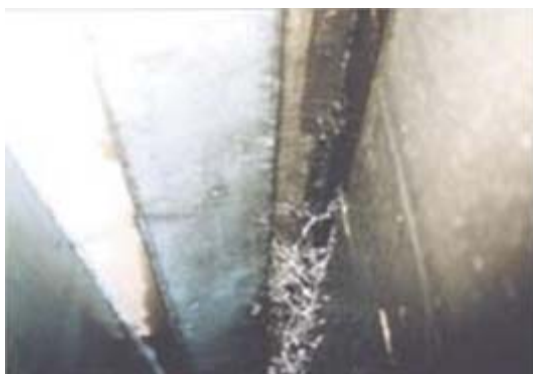
H20.1 Rò rỉ nước từ khe co giãn
