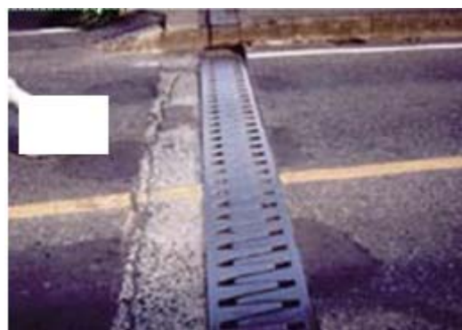
H25.7 Vết nứt tại phần xây chèn của khe co giãn
