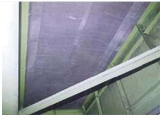
H6.9. Các vết nứt trên bản mặt cầu
