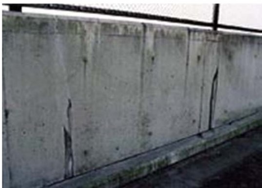
H6.3. Thành lan can bị nứt
