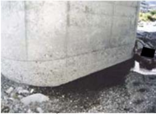
H26.1 Đất bị rửa trôi tại móng
