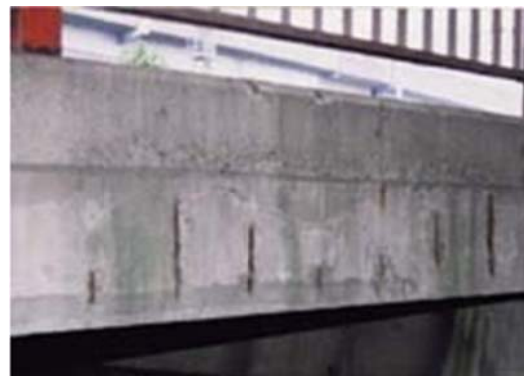
H7.2. Bong tróc bê tông, cốt thép lộ ra
