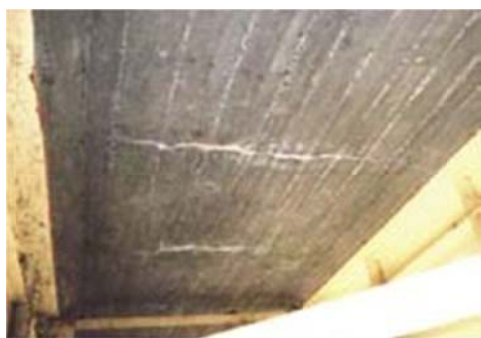
H11.9 Vôi bột từ các vết nứt trên đáy của bản mặt cầu
