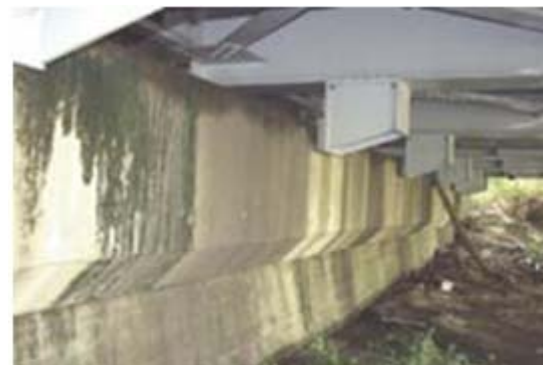
H19.8 Phai màu trên bề mặt bê tông do nước chảy
