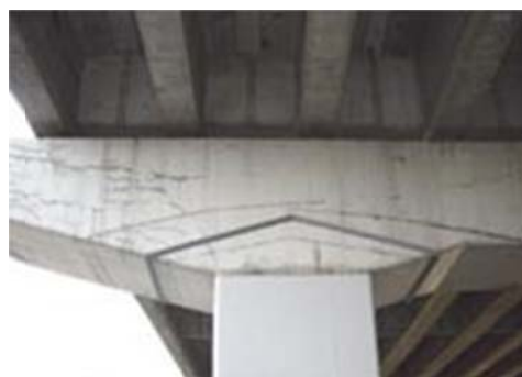
H5.12. Màng sơn trên bê tông đã bị xuống cấp
