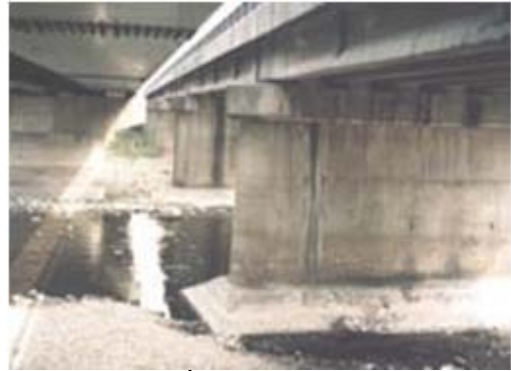
H26.2 Đất bị rửa trôi tại móng
