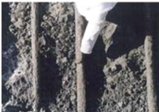
H15.4 Mặt trên của bê tông bản mặt cầu chuyển thành cát sau đó ăn mòn thép.
