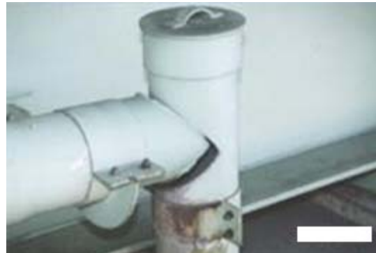
H20.9 Đứt gãy với ống thoát nước
