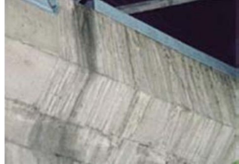
H8.8 Thoát nước qua bề mặt và xuất hiện vôi bột
