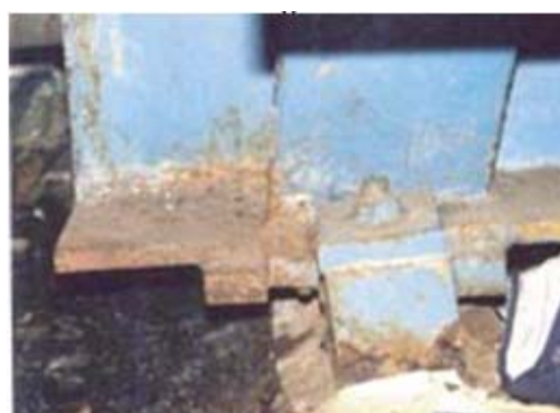
H25.9 Nghiêng và ăn mòn tại gối cầu
