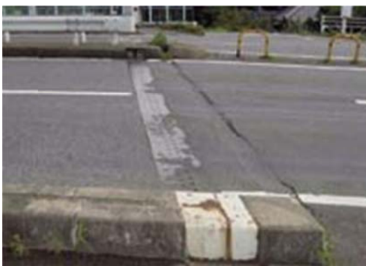
H14.8 Hư hỏng tại phần xây chèn của tường chắn của mố
