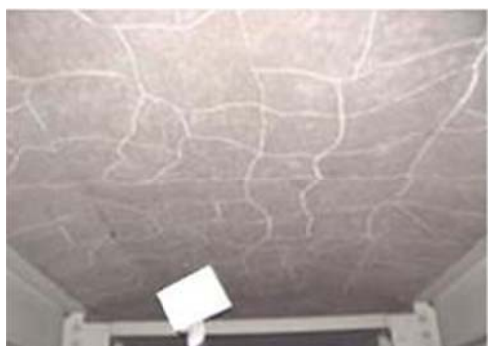
H11.5 Nứt hình chữ nhật tại đáy của bản mặt cầu
