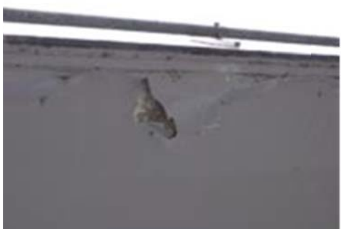
H5.11. Màng sơn trên bê tông đã bong tróc
