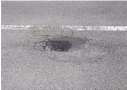
H14.5 Ổ gà trên mặt đường
