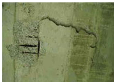
H12.10 Bong tróc và cốt thép lộ ra tại dầm
