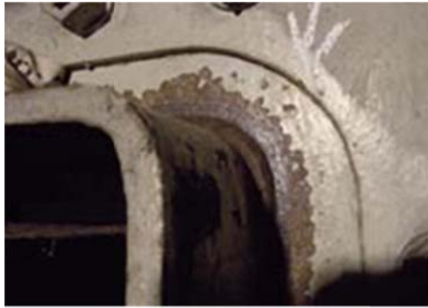
H2.1 Nứt tại khu vực hình R tại đầu dầm
