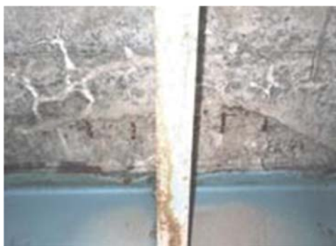
H11.7 Nứt, bong tróc bê tông, cốt thép lộ ra tại đáy của bản mặt cầu
