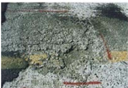
H15.3 Mặt trên của bê tông bản mặt cầu chuyển thành cát.
