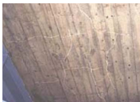
H11.4 Nứt hai hướng tại đáy của bản mặt cầu
