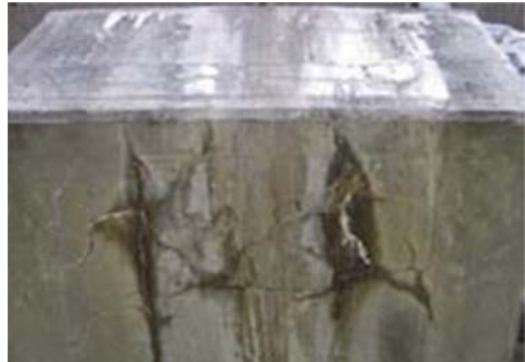
H8.10 Nước từ vết các nứt và xuất hiện vôi bột
