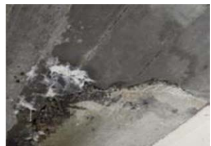
H9.9 Vôi bột, nứt, với rò rỉ trên bản mặt cầu
