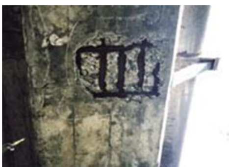
H12.9 Bong tróc và cốt thép lộ ra tại dầm
