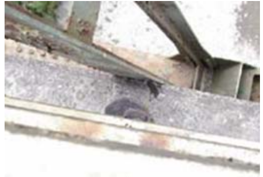
H21.2 Âm thanh do va chạm giữa thanh xiên của giàn và bản mặt cầu bê tông dự ứng lực
