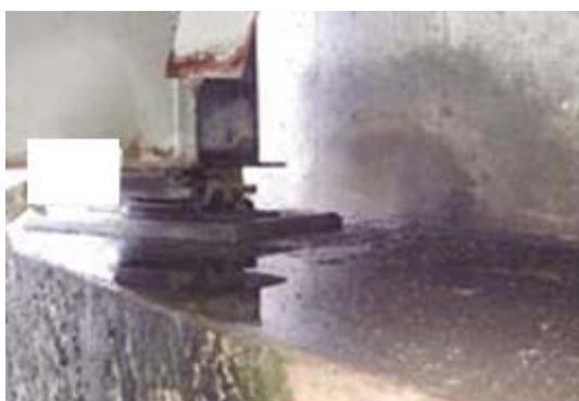
H20.4 Nước đọng tại chân gối cầu
