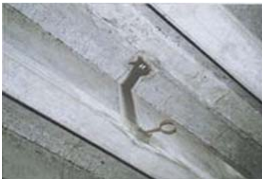
H20.10 Đứt gãy với ống thoát nước
