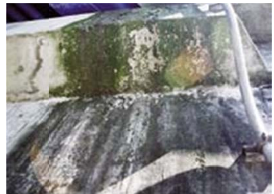
H17.6 Phai màu do nước rò rỉ trên bề mặt
