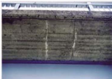
H8.9 Nước từ các vết nứt và xuất hiện vôi bột
