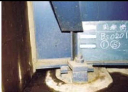
H13.2 Sự va chạm giữa đầu dầm và mố, và hư hỏng trên bản uốn cong của gối cầu
