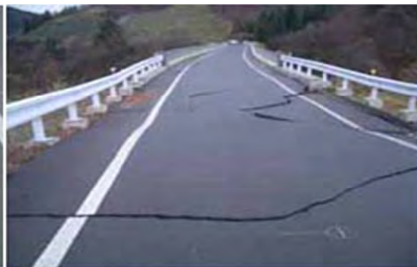
Ảnh 7.9 Lún mặt đường
