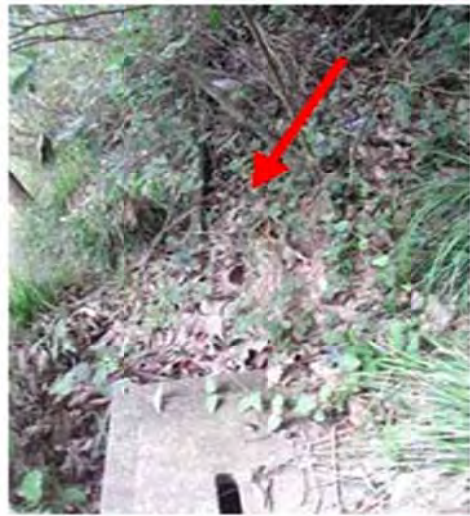
Ảnh 6.9 Hũ hỏng chức năng của rãnh thoát nước Hạng D.Nên được dọn sạch.
