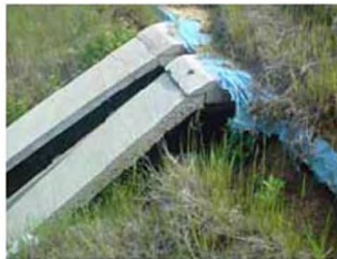
Ảnh 2.2 Hư hỏng hệ thống thoát nước do lún
