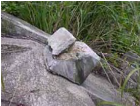
Ảnh 3.2 Hư hỏng của đầu bê tông
