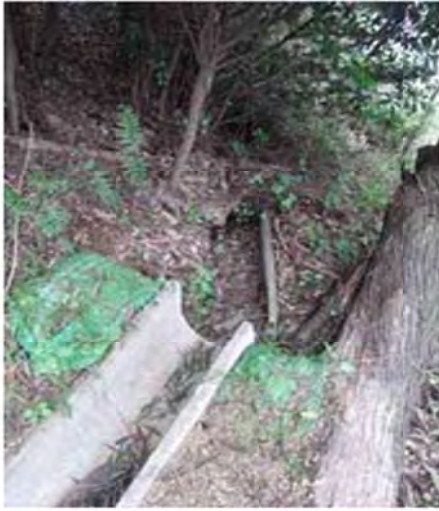
Ảnh 6.8 Khe hở rãnh thoát nước Hạng E và nó nên được sửa chữa..
