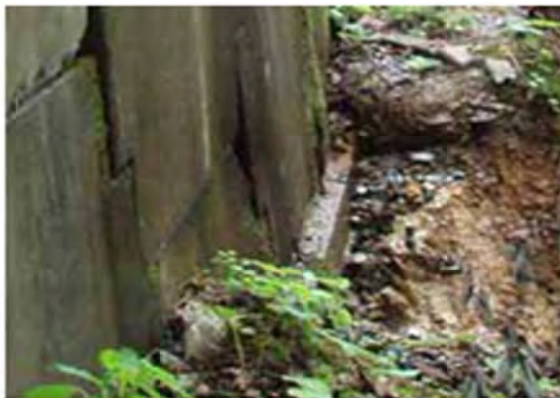
Hình 7.6 : Xói mòn tại chân bệ
