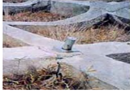
Ảnh 3.1 Hư hỏng của kết cấu chịu áp lực dương của đất
