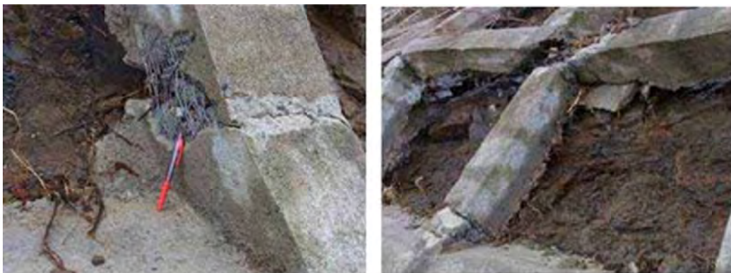
Ảnh 6.5 Vỡ khung bảo vệ của mái dốc
