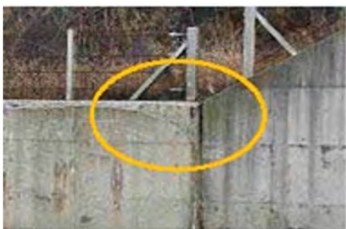
Ảnh 5.5 Bong tróc và nứt trên bê tông (Tường chắn)
