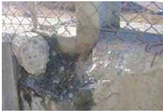
Ảnh 5.4: Bong tróc và nứt bê tông (tường chắn))
