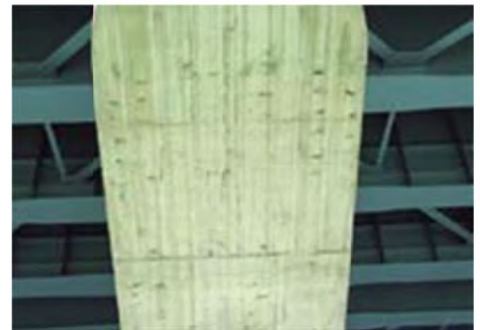
P7.4. Peeling rebar exposure
