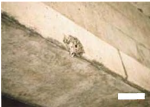
P7.3. Peeling rebar exposure
