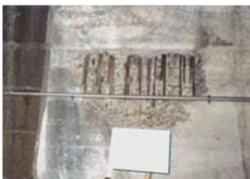
P7.5. Peeling rebar exposure
