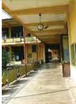
写真-1：ヤンゴン工科大学の既存施設の外観。メイン棟と同時期に建設されたが塗り直しはされていない。
