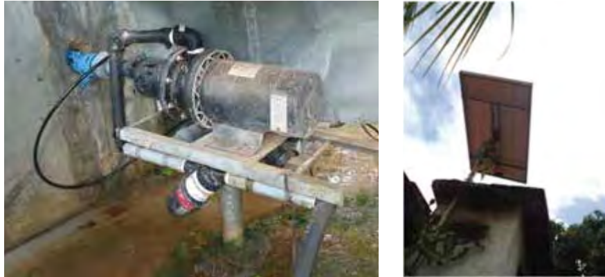
写真 IV-3 ソーラーポンプ
