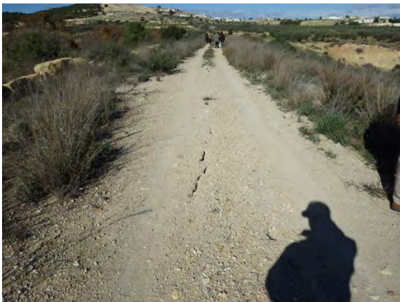
堤体天端クラック
