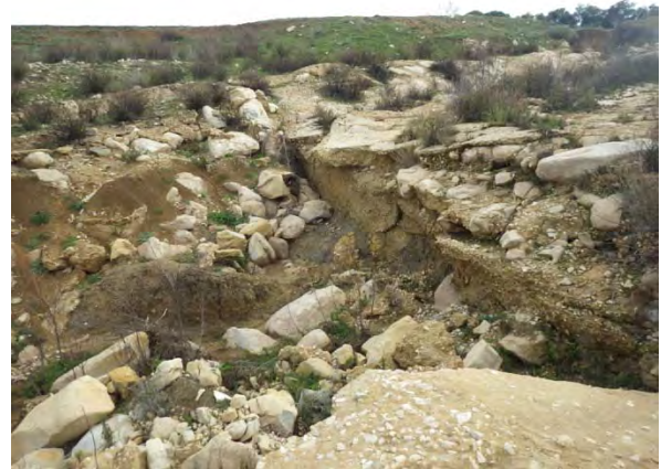
激しく侵食された洪水吐急流部始点
