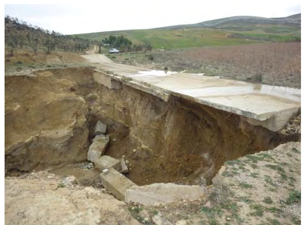
洪水吐流入部破壊状況
