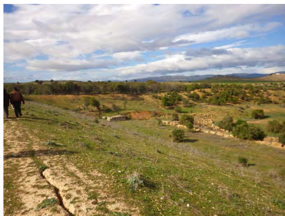
堤体下流面と天端路肩クラック
