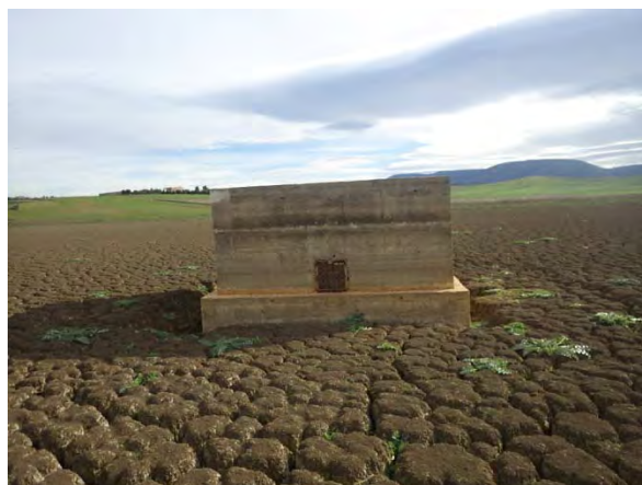
取水塔頂部と堆砂
