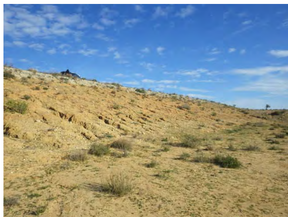
堤体下流面。ガリ浸食が進行している。
