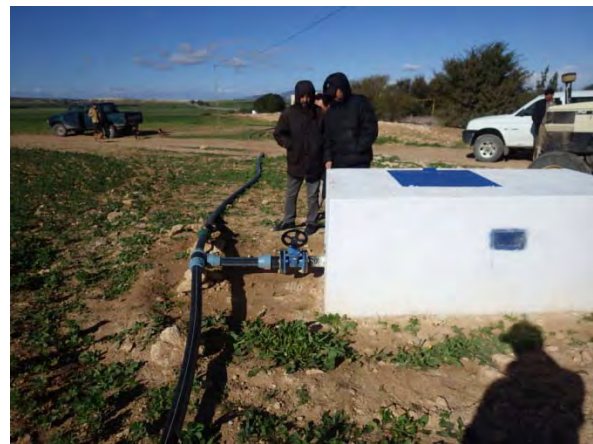
2013年9月完成圃場付近パイプライン設備
