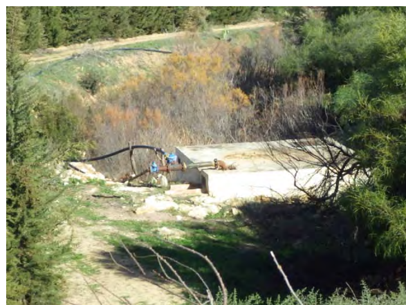
取水放流工と配水パイプ
