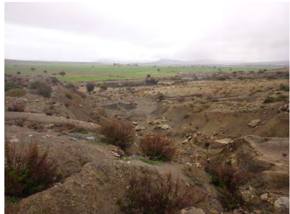
激しく侵食された洪水吐急流部
