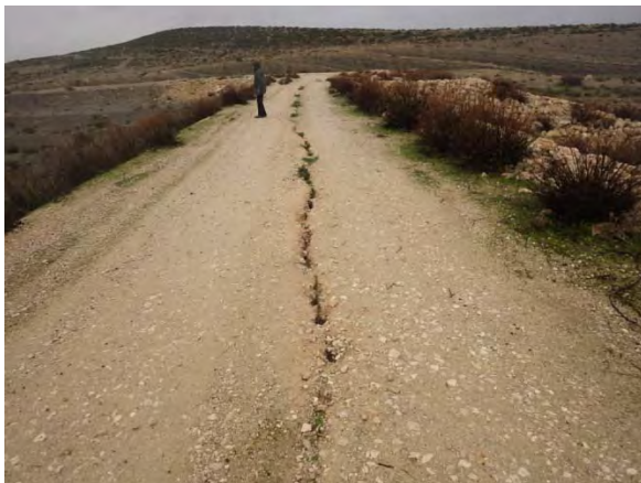
堤体天端クラック
