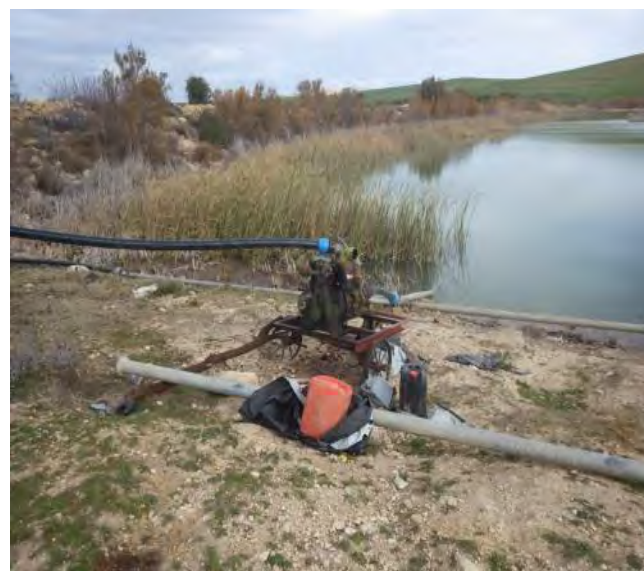
図 3.12 貯水池からの取水ポンプ SI-2 Mechaiker (Jan. 23, 2014)
