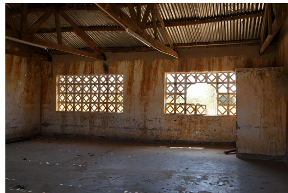
R6 Mzoma CDSS 老朽化が著しく建て替えが必要である。
