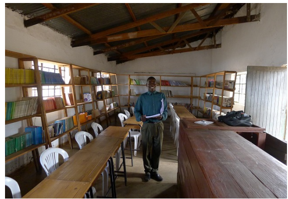
R3 Chimwalira CSS 図書室棟はレンガ造で一部破損している。
