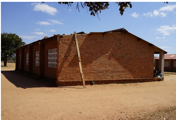
R6 Mzoma CDSS 教室棟の1棟は屋根が破損している。
