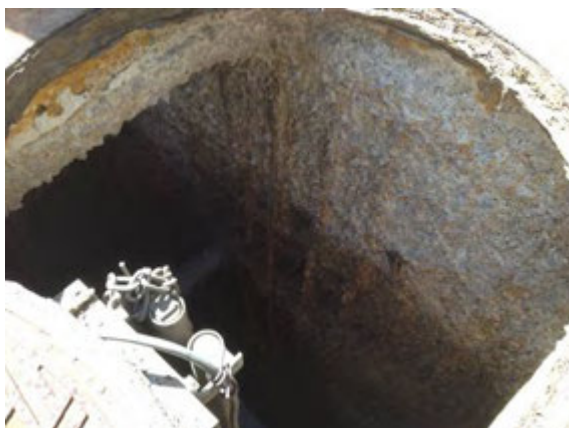
放流ポンプ槽の腐食状況
