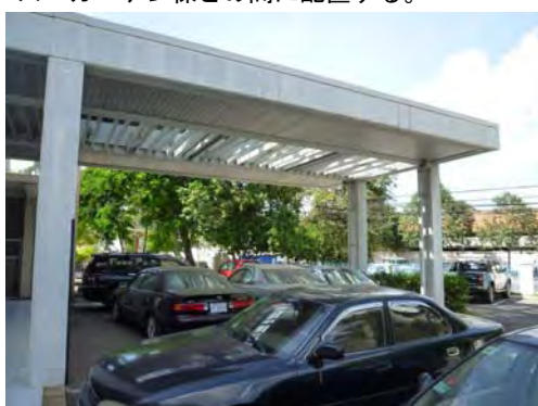
既存センター北棟 駐車場不足のため、既存センター北棟車寄せは駐車スペースとなっている。
