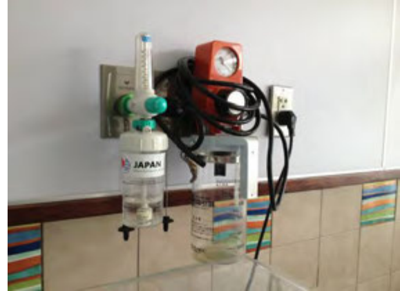
NCU 医療ガス使用状況
