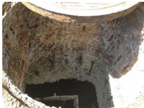
沈殿槽の腐食状況
