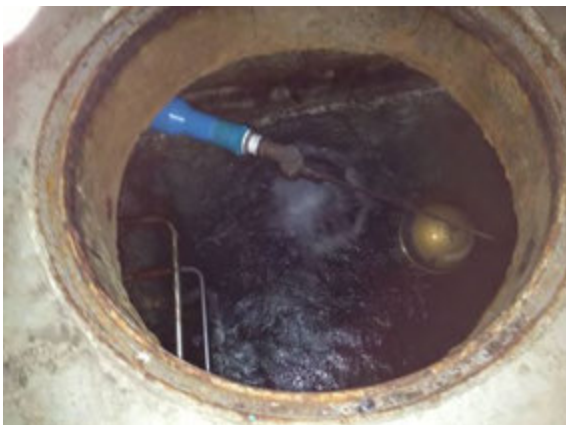
ピット利用市水受水槽状況
