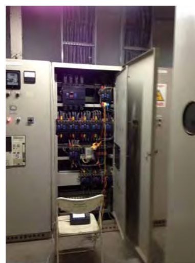
低圧配電盤内部 (電力計測中)
