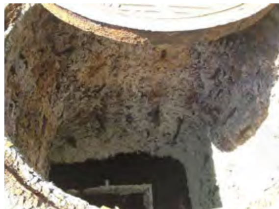
沈殿槽の腐食状況
