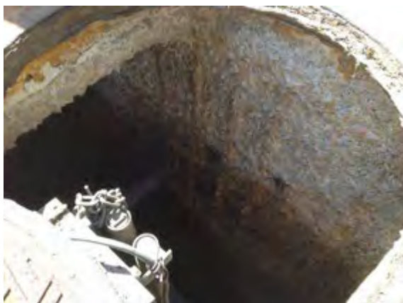
放流ポンプ槽の腐食状況
