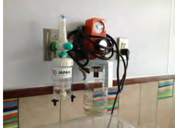
NCU 医療ガス使用状況
