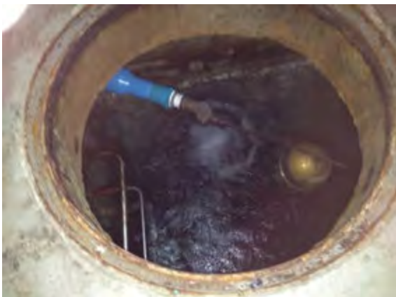
ピット利用市水受水槽状況
