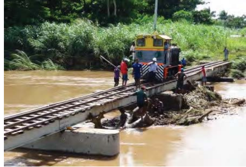
写真-10 ナワカ川（橋梁箇所）／洪水後
