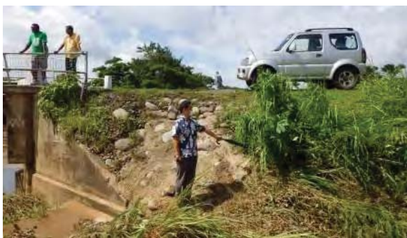
③ 3 ナワカ川橋梁（洪水後） （ナワカ川：約 1km 地点）
