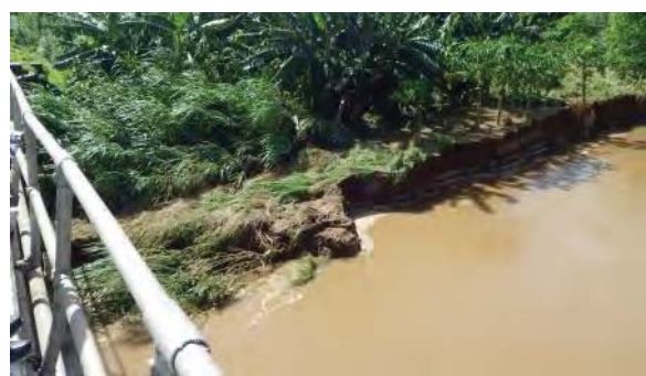
③ 4 ナワカ川橋梁（洪水後） （ナワカ川：約 1km 地点）
