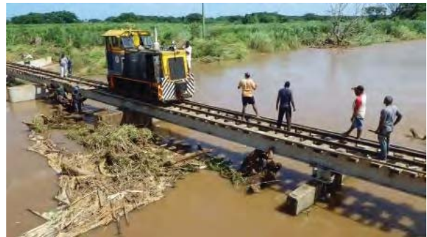
③ 2 ナワカ川橋梁箇所（洪水後） （ナワカ川：約 1km 地点）
