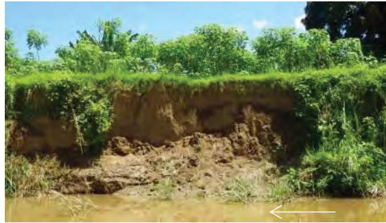
ナンディ川中・下流域の河岸侵食の状況
