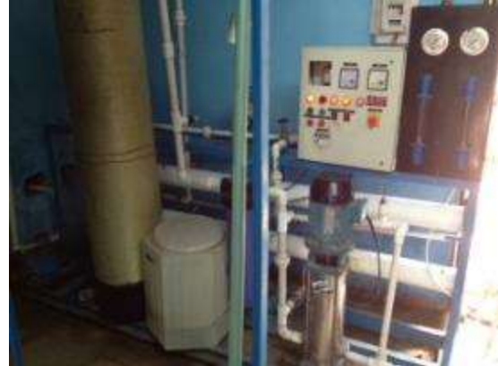
水処理装置 (RO 膜)
