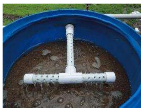
凝集槽の上澄み水がパイプから濾過槽に流入する。
