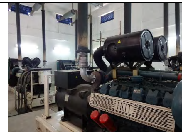
126. セブケット病院の発電機室：バックアップ電気設備は、2006年建設の発電機室に1,600KVA x 2基、650KVA x 4基。オイルタンク1,000L(内部)+2,500L(外部)を備えている。(発電機は全体の70%をカバーする容量である)
