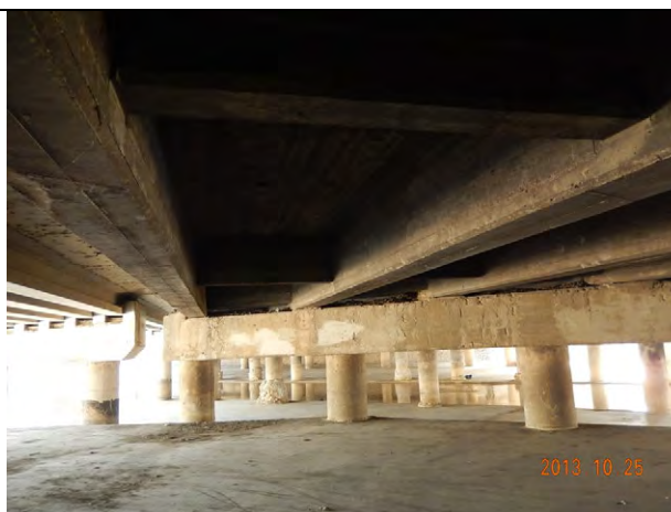
37. アンカラ-イズミル道路上にあるニルファー橋梁の橋桁部分：目視にて橋脚、橋桁を受ける梁の劣化、鉄筋露出が確認できる。
