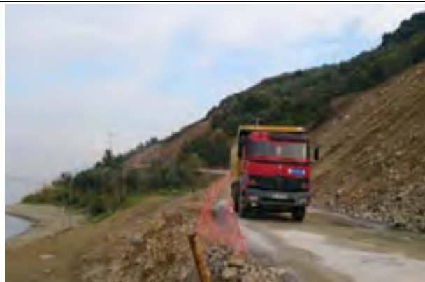
35. ゲムリックームダンヤ間の道路：幅が狭く、土砂崩れ危険性のある箇所がある。ブルサ市にて拡幅工事を一部開始している。
