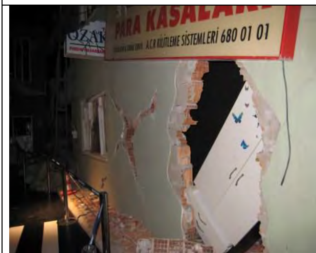
83. レンガの壁の亀裂や崩壊の展示
