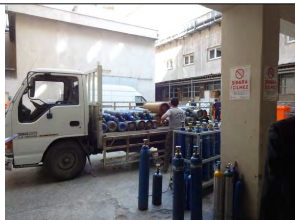
100. ハジュテペ大学病院医ガスボンベ置き場：大学の施設は1960年代に建設され、その後改修を繰り返しており、医ガスのボンベ置き場の位置が施設の中央になり、災害時の対策が必要になっている。
