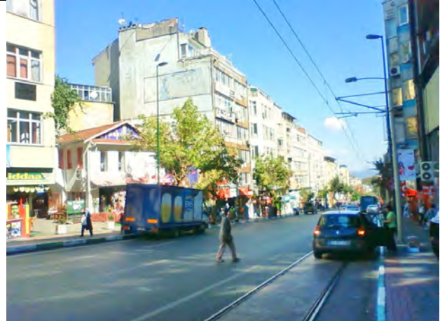
18. オールドタウンの繁華街 (6) : 幹線道路に面して老朽化した建物が建ち並ぶ様子がわかる。これらが大地震により倒壊した場合は、道路閉塞の恐れがある。(オスマンガジ区)
