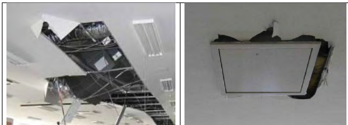
図 4.4.33 天井材の破損・落下
