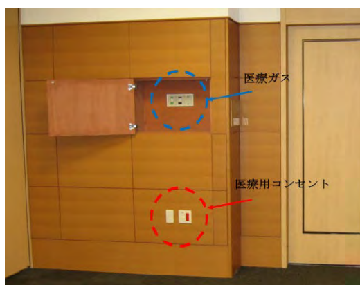
図 4.4.23 非常用医療ガスのアウトレットと医療用コンセント（日本の病院）
