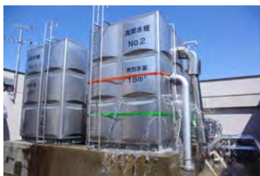
図 4.4.28 受水槽のパネル破損・水漏れ
