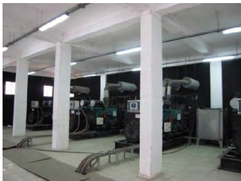
図 4.4.30 自家発電装置
