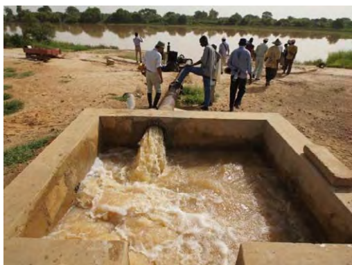
Eau envoyée dans un répartiteur de Diatar2 par la pompe.
