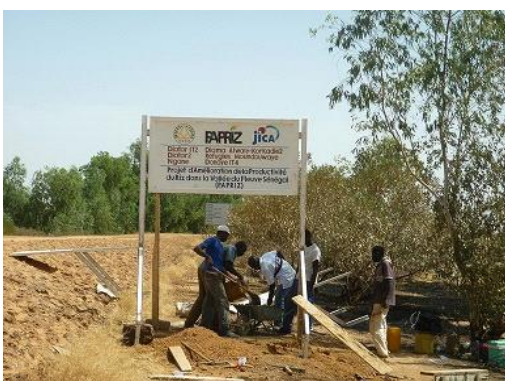
ポドル灌漑施設改修工事の実施地区を知らせる 標識の設置工事。 2011年11月 (Podor、プロジェクト地区)
