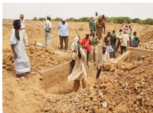
農民の参加による、既存水路の補修工事。 2011年6月 (Podor, Korkadie 地区)
