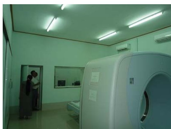
No.30 据付けられたCTスキャン
