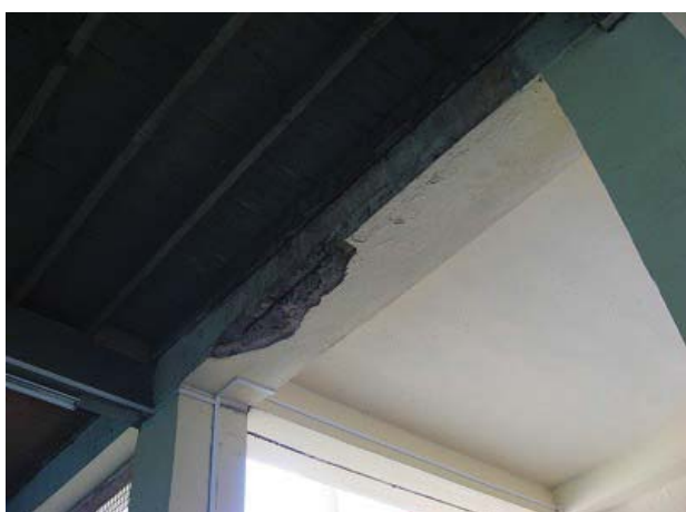
No.12 梁のコンクリートが爆裂し、鉄筋が露出している。 2階床は木造で床がきしんでいる。
