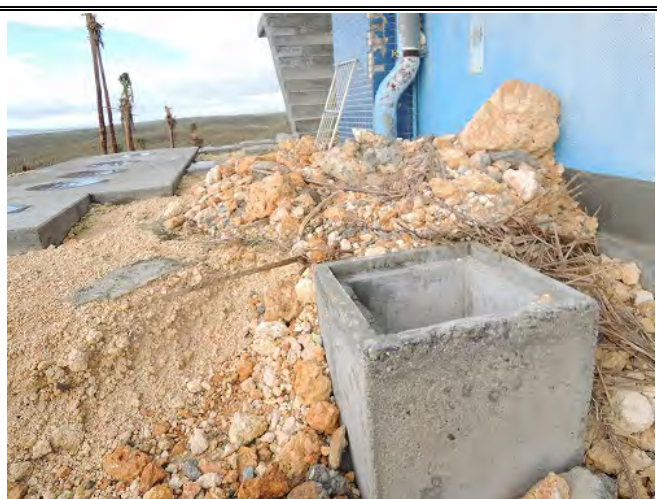
排水用マンホール（コンクリート製蓋が破損）
