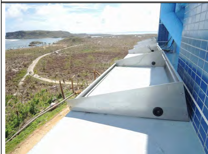
2階庇（南側のソーラーパネルフレーム）
