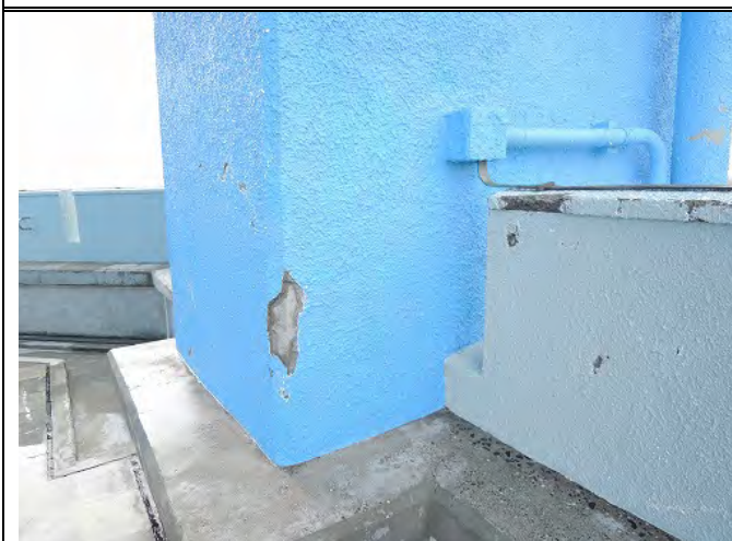
5階観測デッキ (エアコン室外機の衝突跡)
