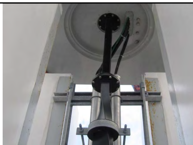
6 階レドーム室 (ペダスタル下部の導波管)
