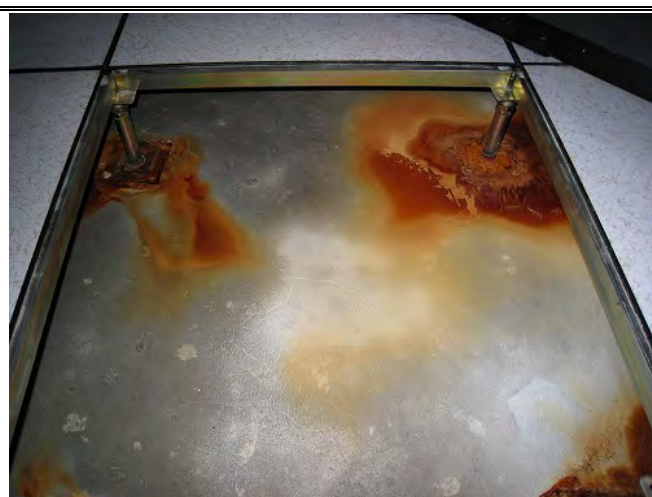
M4階レーダー機械室 (OAフロア床下)
