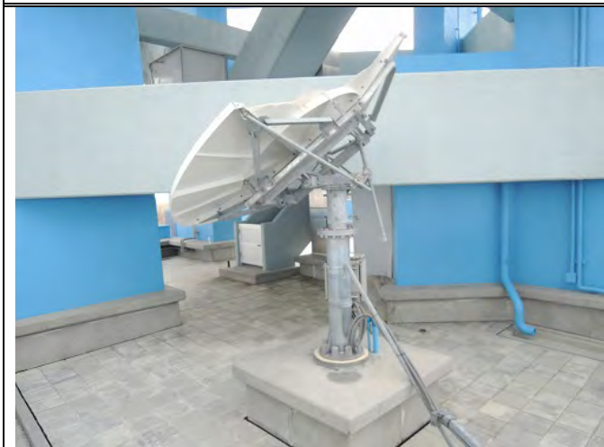
2階屋上（VSAT アンテナ）
