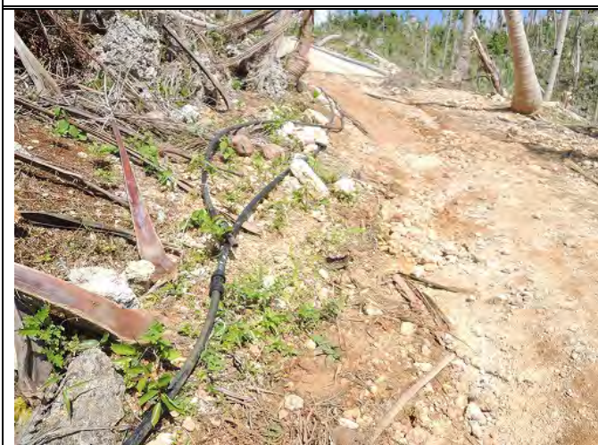
破損した井戸の給水配管
