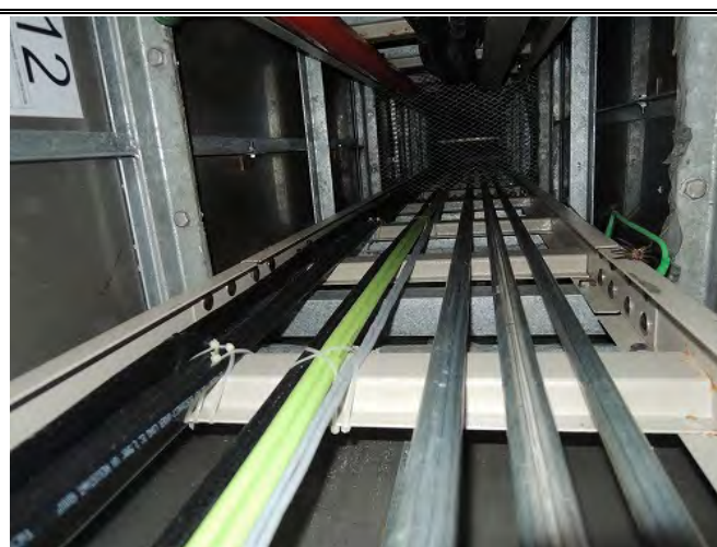
2～4階階段 (ケーブルダクト内部)
