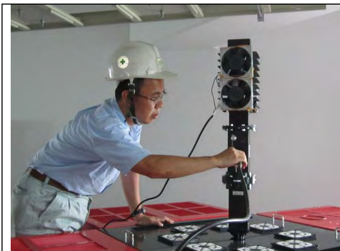
M4 階レーダー機械室 (送信装置)
