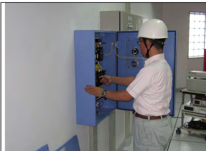
M4 階レーダー機械室 (レーダー用分電盤)
