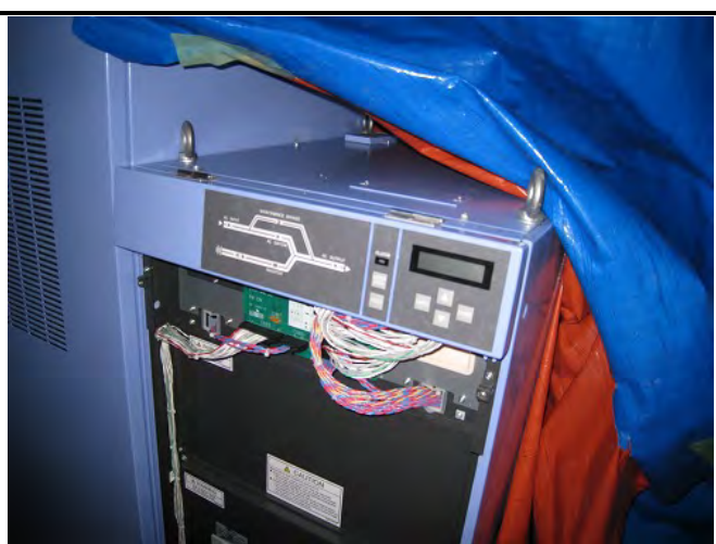
1階パワー供給室（電源供給キャパシタ）
