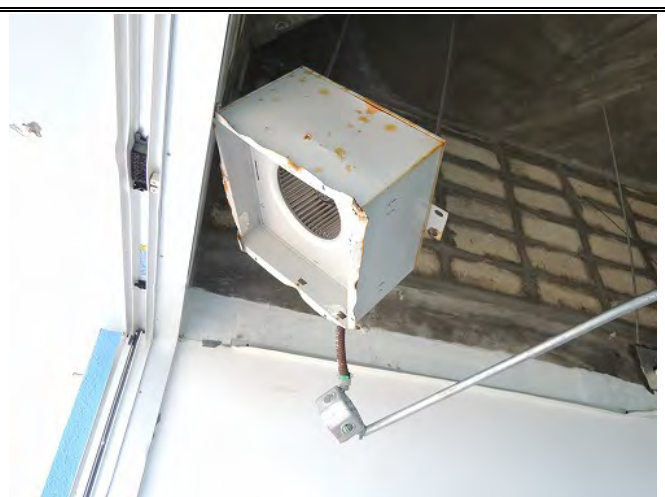
1階データ解析室 (天井換気扇)
