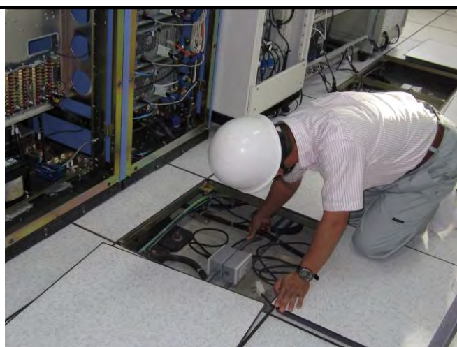
M4 階レーダー機械室 (OA フロア下)
