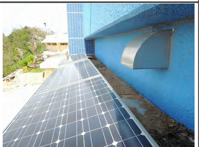
2階庇（西側のソーラーパネル）
