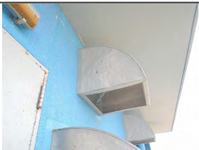
外部ステンレス製フード（強風の飛び石による）
