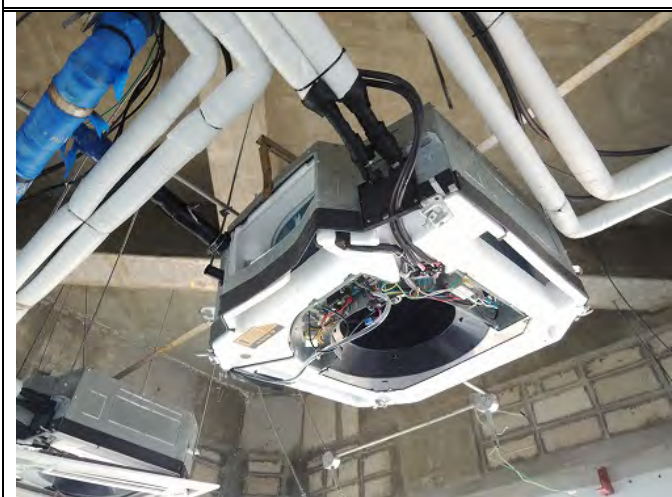
1階観測室 (エアコン室内機)
