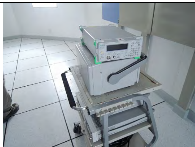
M4 階レーダー機械室 (測定器)
