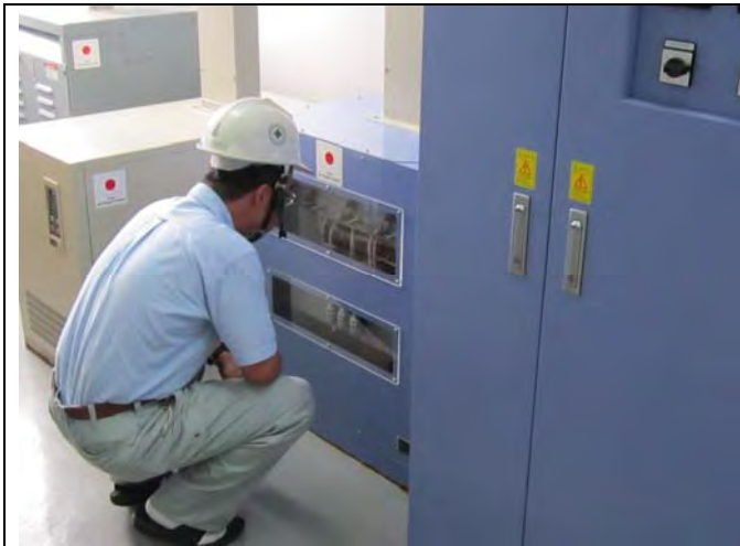
1階電気室（耐雷トランス・AVR）
