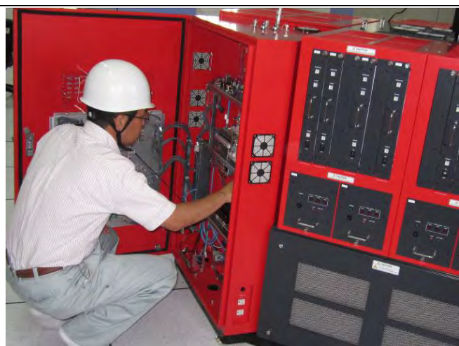
M4 階レーダー機械室 (送信装置)
