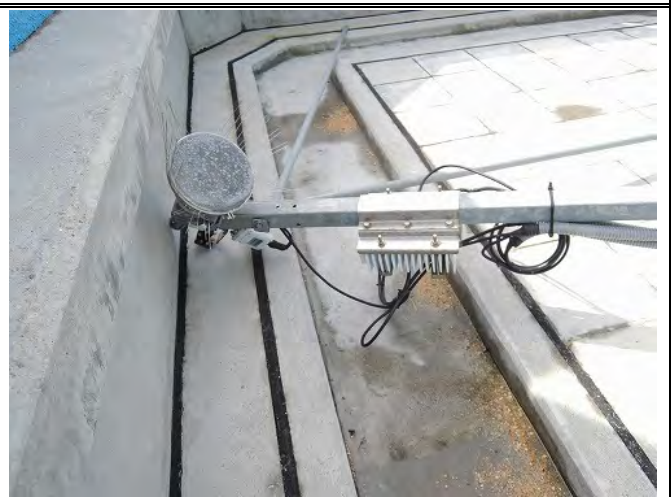
2階屋上（VSAT アンテナ）
