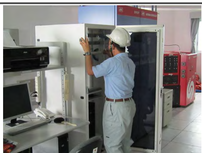
M4 階レーダー機械室 (データプロトコル変換装置)
