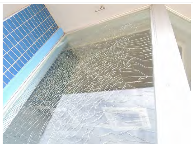
1階観測室 (飛び石による破損した窓ガラス)
