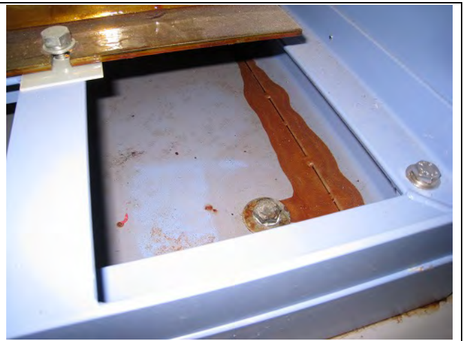
1階電気室（耐雷トランス）
