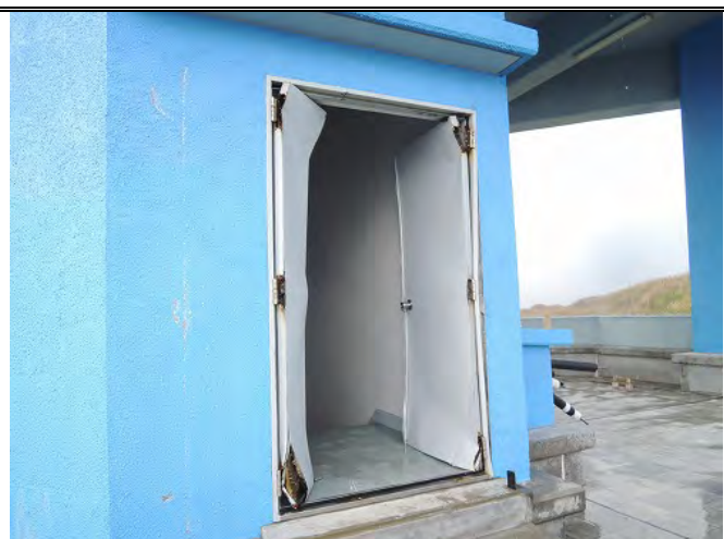
5階観測デッキ (スチールドア)
