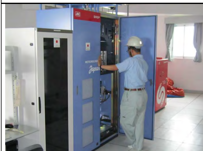
M4 階レーダー機械室 (受信信号処理装置)
