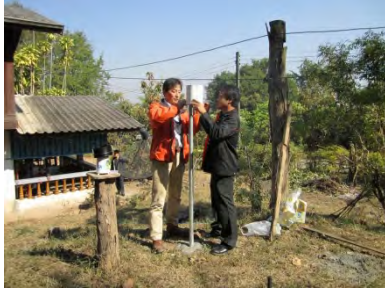
雨量計の設置状況
