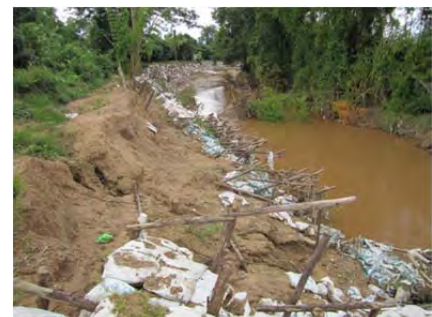
図 3.5.2 護岸の被災状況
