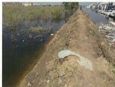
堤防の様子。見えているのは、今回洪水の積み増し分。旧堤防は、水没。
