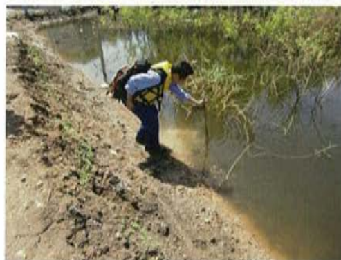
旧堤防の固さを調べている様子。専門家が立っている場所が旧堤防の天端。後ろは、今回洪水に備えて積みました堤防で、もろい。
