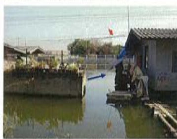
※2 排水先の影響(吐出水門)
