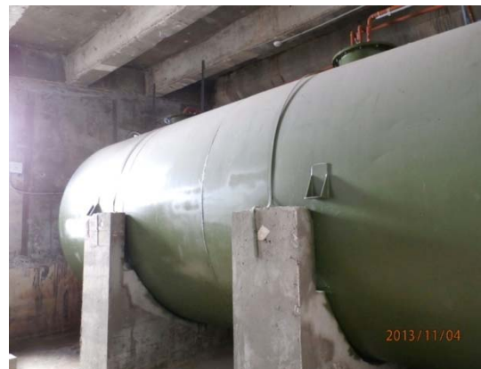
Réservoir à carburant de 25 000 litres
