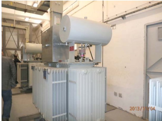
Transformateurs de poste électrique 10 000V
