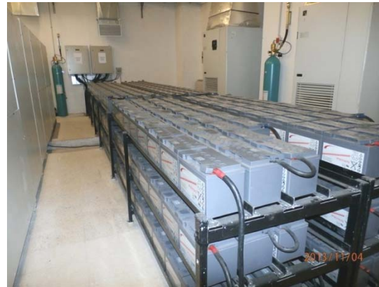
Batteries de l'alimentation sans interruption
