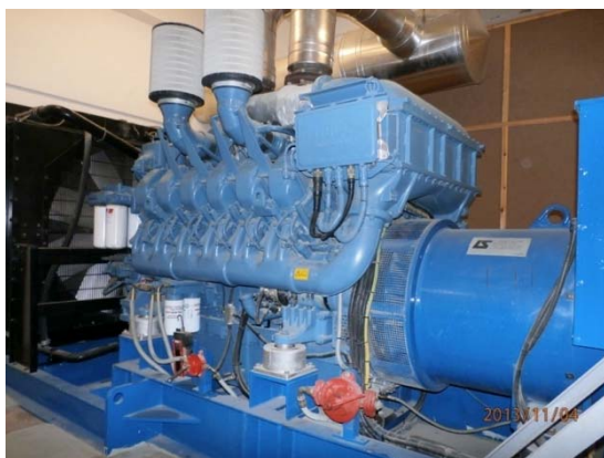
Générateurs de 1 250 kVA
