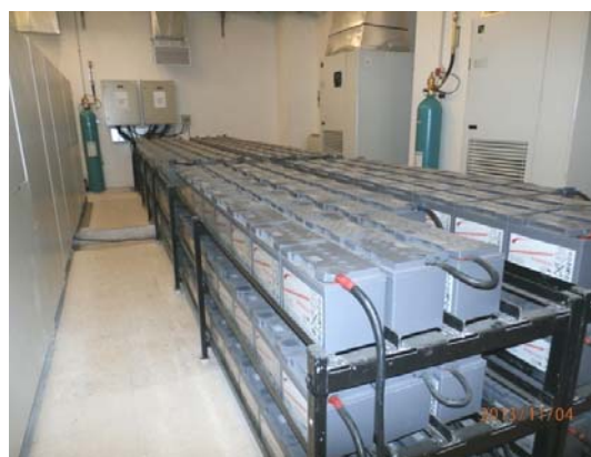
UPS 用バッテリー
