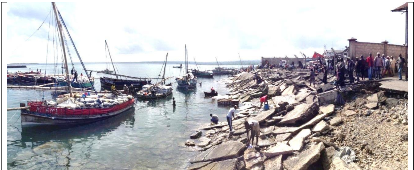
【写真-06】マリンディ漁港(商港側) 崩落したスロープ式岸壁の状況
