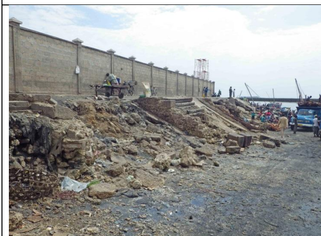
【写真-09】マリンディ漁港(スリップウェイ側) 崩落した護岸の状況
