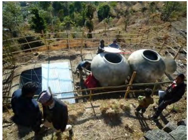
建設された多目的（生活用水及び灌漑）水供給システム
