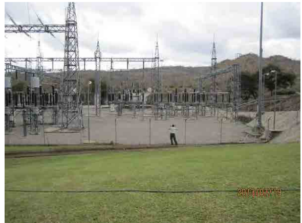
写真－ 8：既設テザニ III 変電所 テザニ III 発電所は、本変電所から 132kV 送電線で送電されている。
