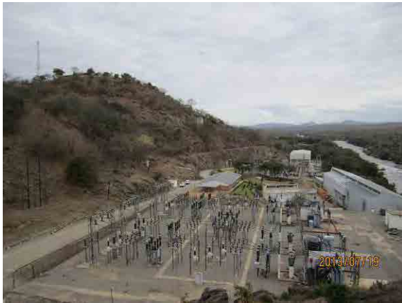
写真－ 7：既設テザニ I・II 発・変電所 テザニ IV 発電所の電力は、テザニ I・II 変電所にて、既設 66kV 送電線網に接続する。
