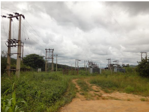
ウスマダム浄水場の33 kV受電設備
