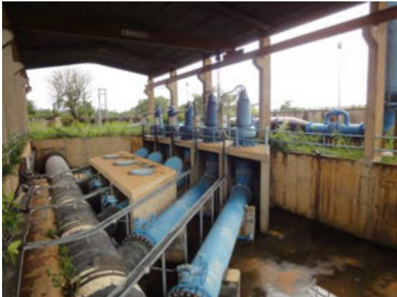
本計画設備の負荷③(取水用ポンプ場)
