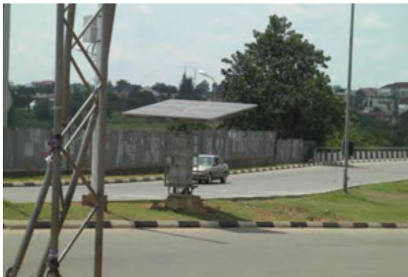
街中に設置されている街灯用の太陽光パネル①
