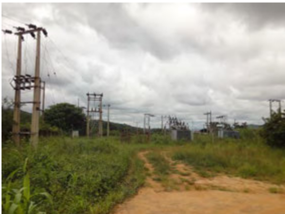
ウスマダム浄水場の33 kV 受電設備
