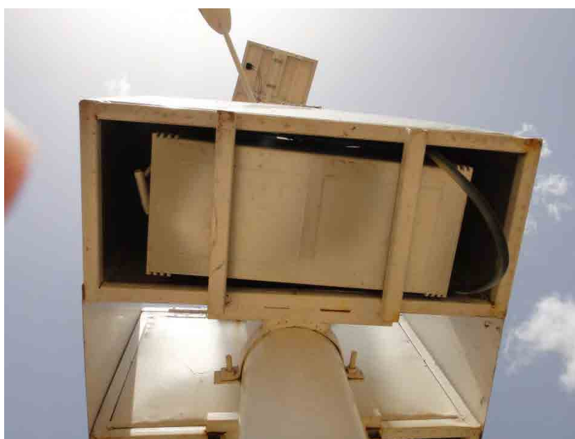
写真 10 蓄電池は高所に格納
