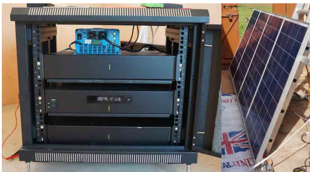
写真 4 ソニー製蓄電システムとインバータ (左)、SunTech製ソーラーパネル (右)
