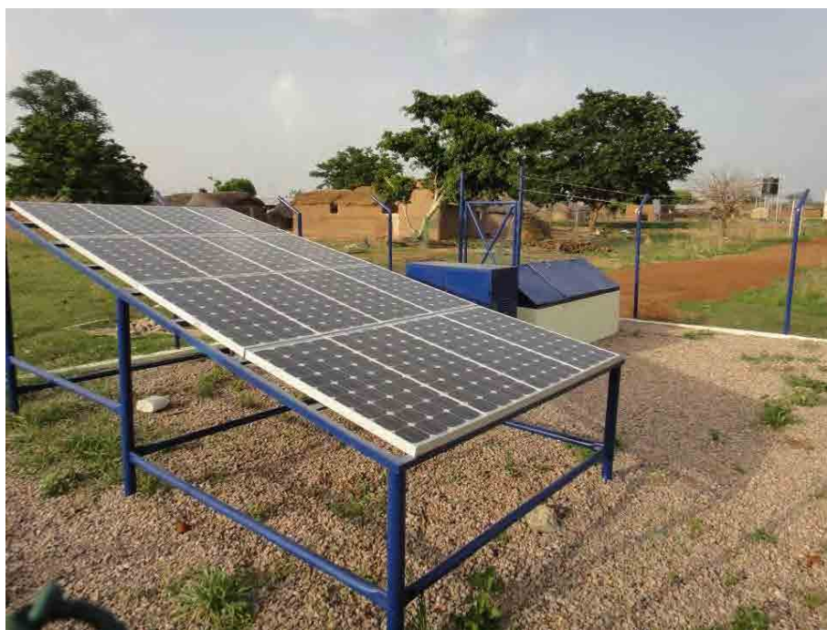
写真 11 UNICEF によるソーラー水道ポンプ、Northern 州
