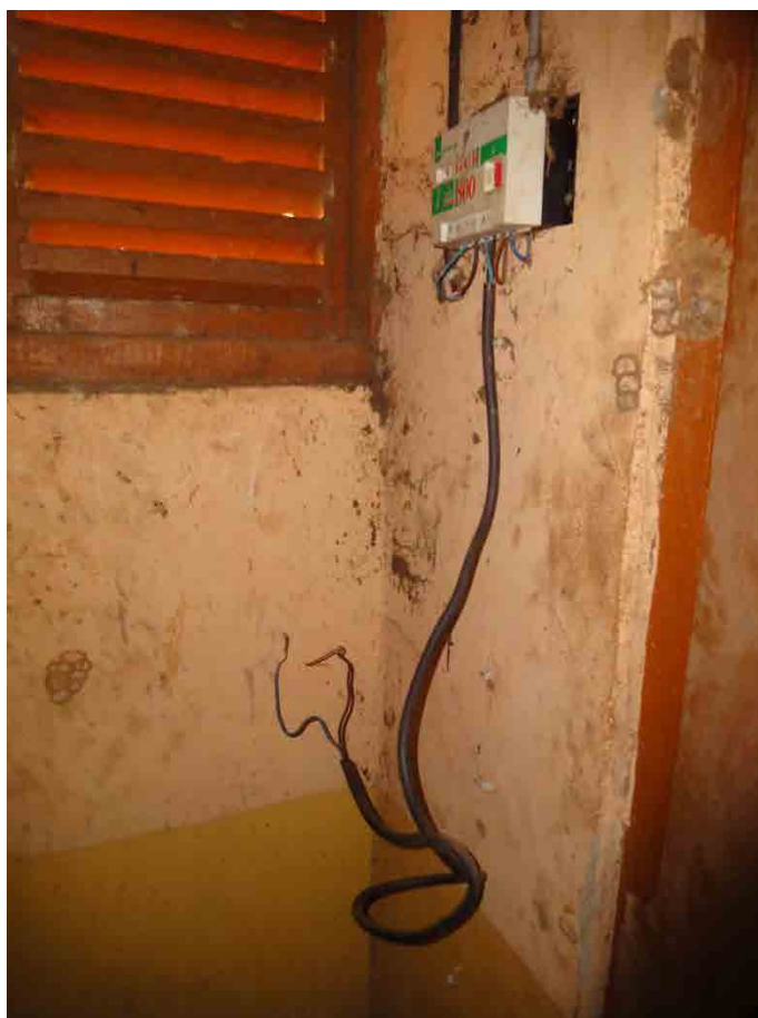
写真 32 バッテリーが取り外された、小学校のソーラー発電による室内照明システム
