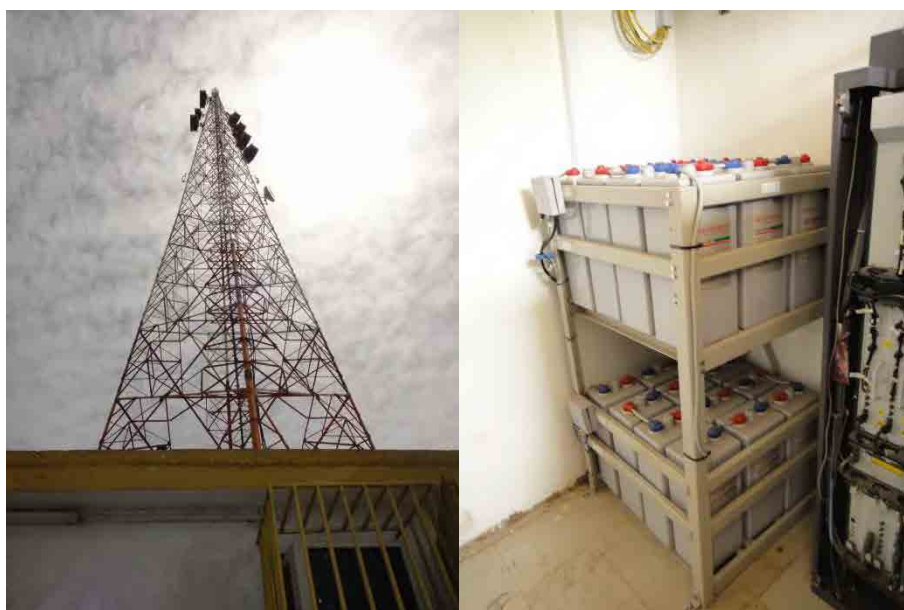
写真 27 無電化地域の携帯電波塔(左)と大量の蓄電池(右)
