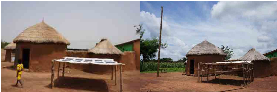
写真 37 PV パネル設置の工夫：架台(左)、小動物よけ柵(右)
