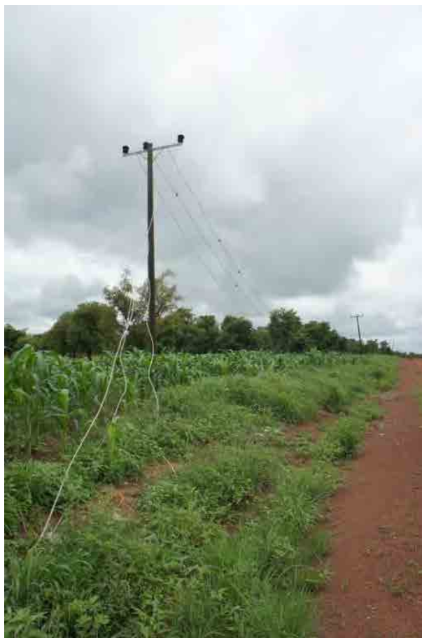
写真 5 雨季にて中断されたグリッド敷設の様子 (2011年8月、Upper West州の幹線道路沿いにて撮影)
