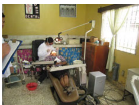
ダンリ旧病院外来の歯科ユニット。老朽化が顕著で ハンドピースは稼働していない。
