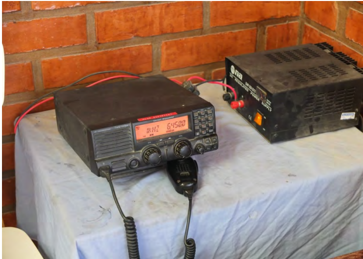
各保健施設をつなぐ無線（第一次保健医療施設）
