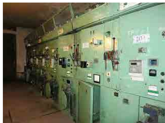
図 5-11 内部の遮断器
