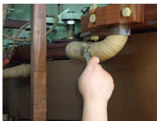
停電を引き起こした変圧器の故障ポイント
