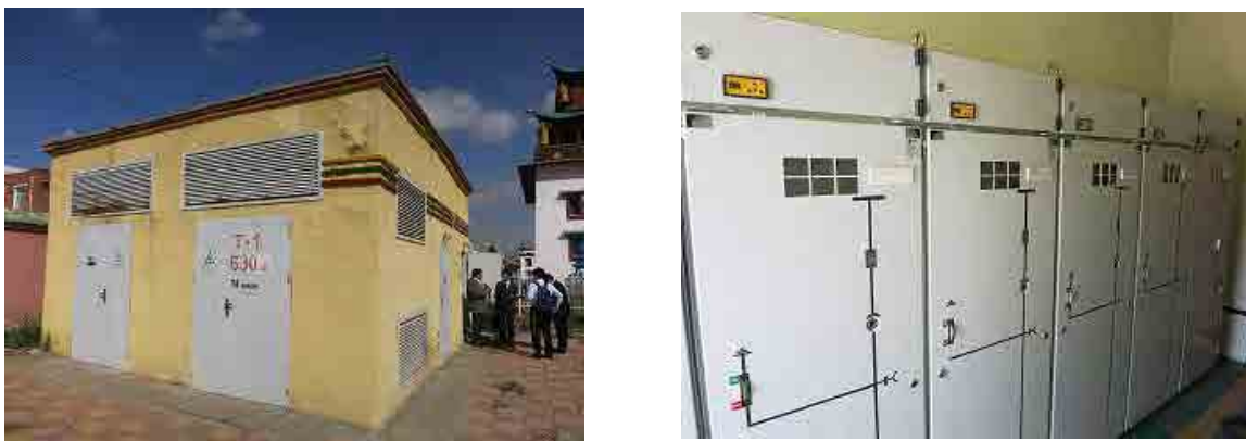
図 5-17 リングメインユニットが設置された配電塔
