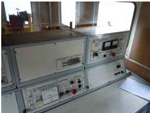
高圧テスト機器 （現在稼働していない）
