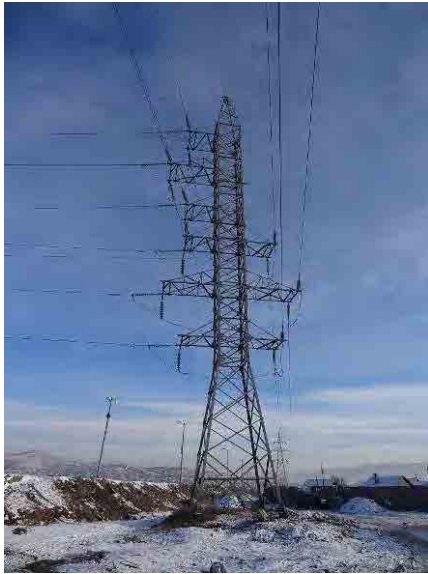
SELBE 変電所分岐点
