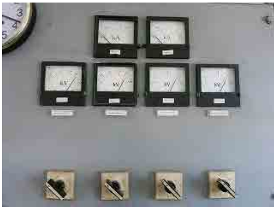
図 5-8 変電所計器盤 (各フィーダの対地間、相間電圧の計測)
