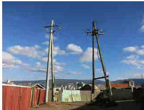
図 5-2 架空配電線設備例
