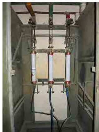
図 5-15 変圧器保護 ヒューズ
