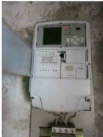
配電塔内集約装置 (3G モデム埋め込み型)
