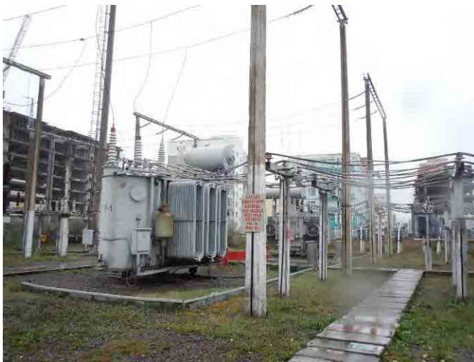
既存変電所の変圧器と母線
