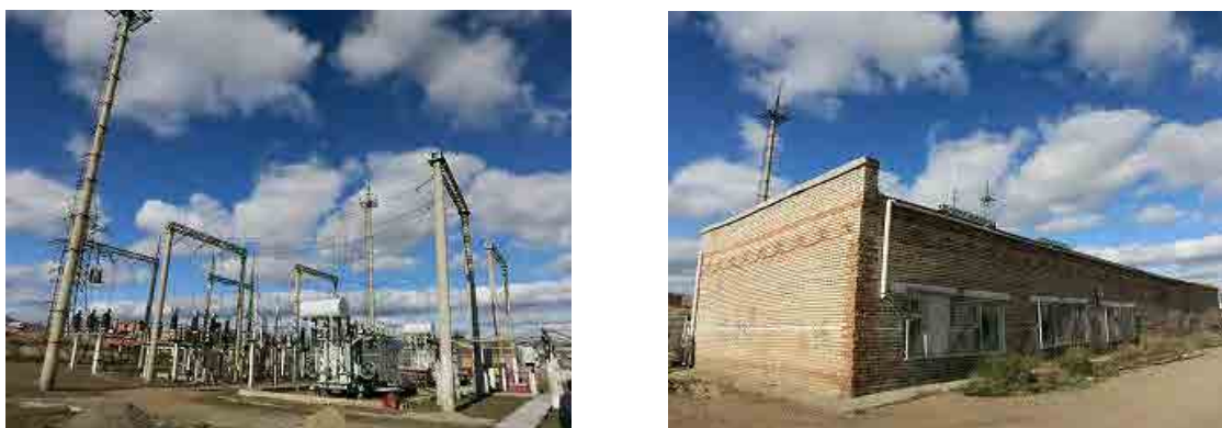
図 5-5 ウマルト変電所(110/10/6 kV)変電所全景
