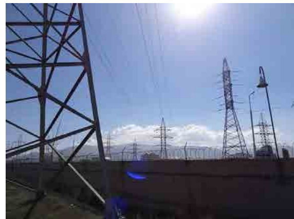
220kV 送電線交差(No.1~No.2)
