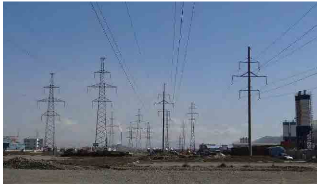
図 4-2 第4火力発電所近傍の架空送電線
