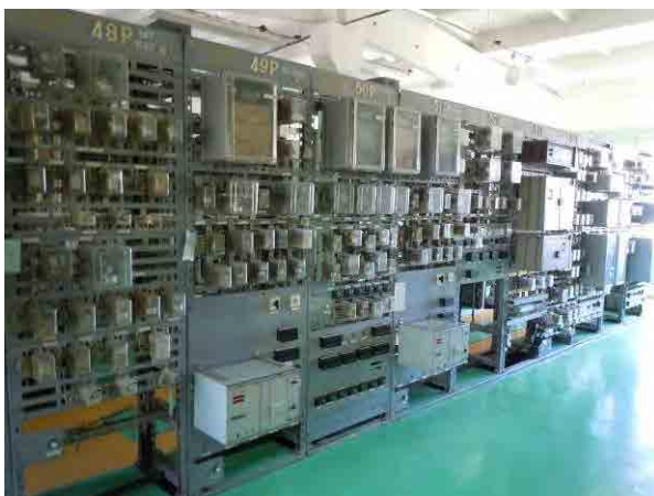
機械式保護リレーとパネル
