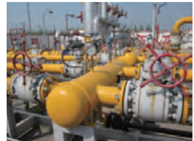
パイプラインとガス圧等の調節をする計器類（焦作市）
