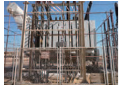
本事業で増設された変電設備
