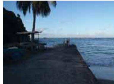
同 老朽化した栈橋（先端が崩壊）
