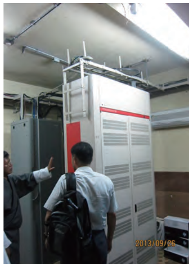
日本の ODA で建設された電話交換機
