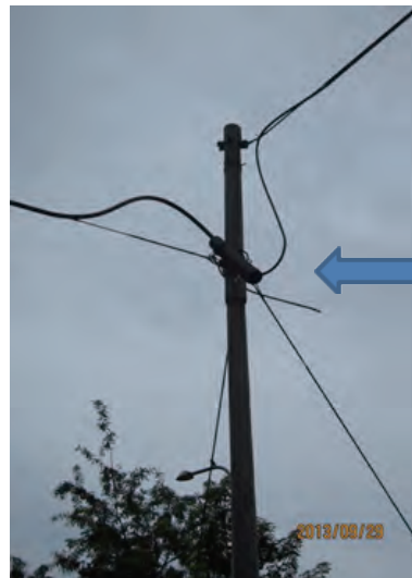
水平に保たれて いないクロー ジャ（雨などが 浸入し故障の原 因となる）
