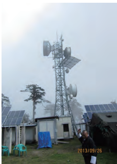
同じくデジタル無線タワー
