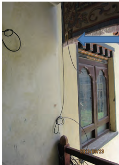
光ファイバー曲 げ（マイクロベ ンディング）で 破断の恐れあり
