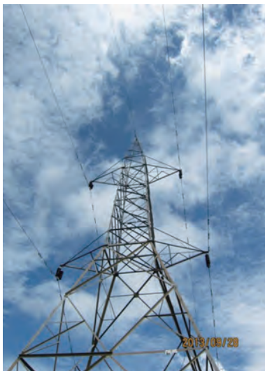
OPGW と送電塔
