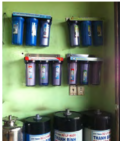
北部農村で使われる逆浸透膜システム
